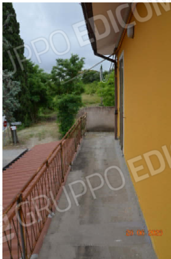
Balcone privo di pavimentazione e ringhiera non a norma.
