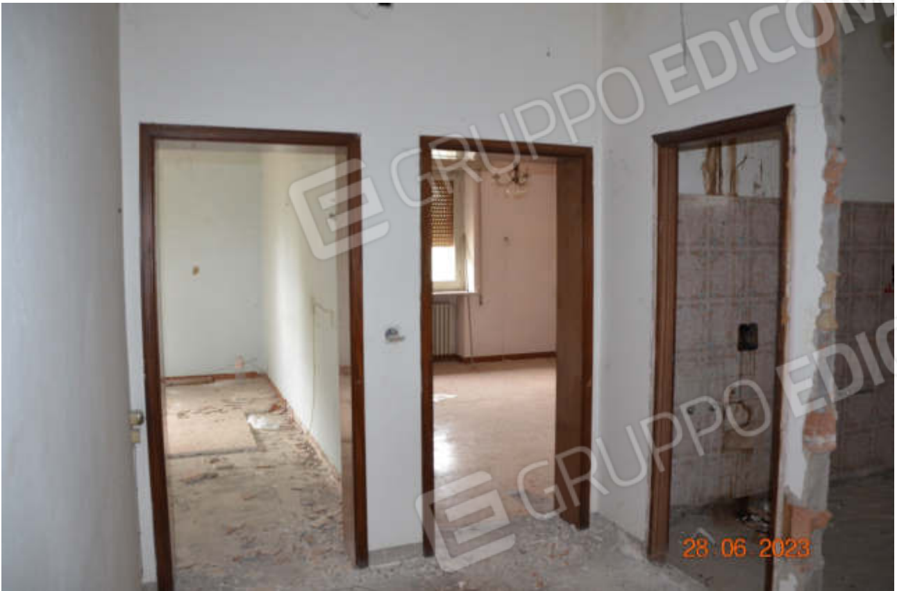
Disimpegno, a sinistra e al centro una camera, sulla destra un bagno in costruzione.
