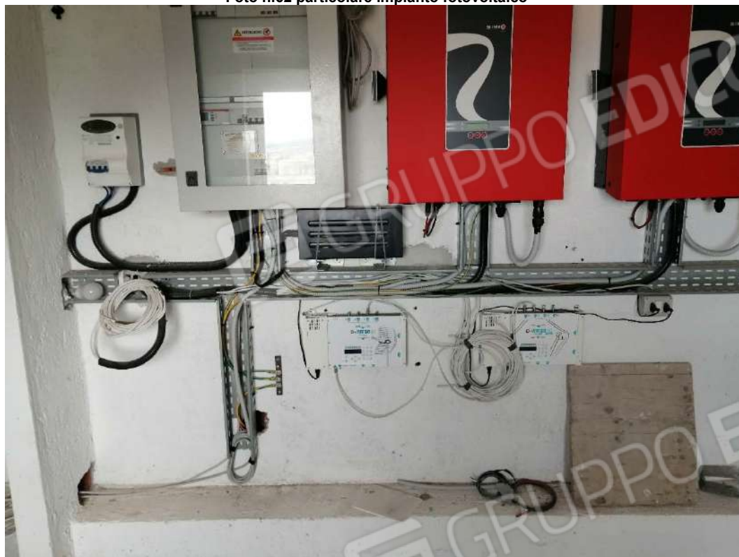
Foto n.62 particolare impianto fotovoltaico
