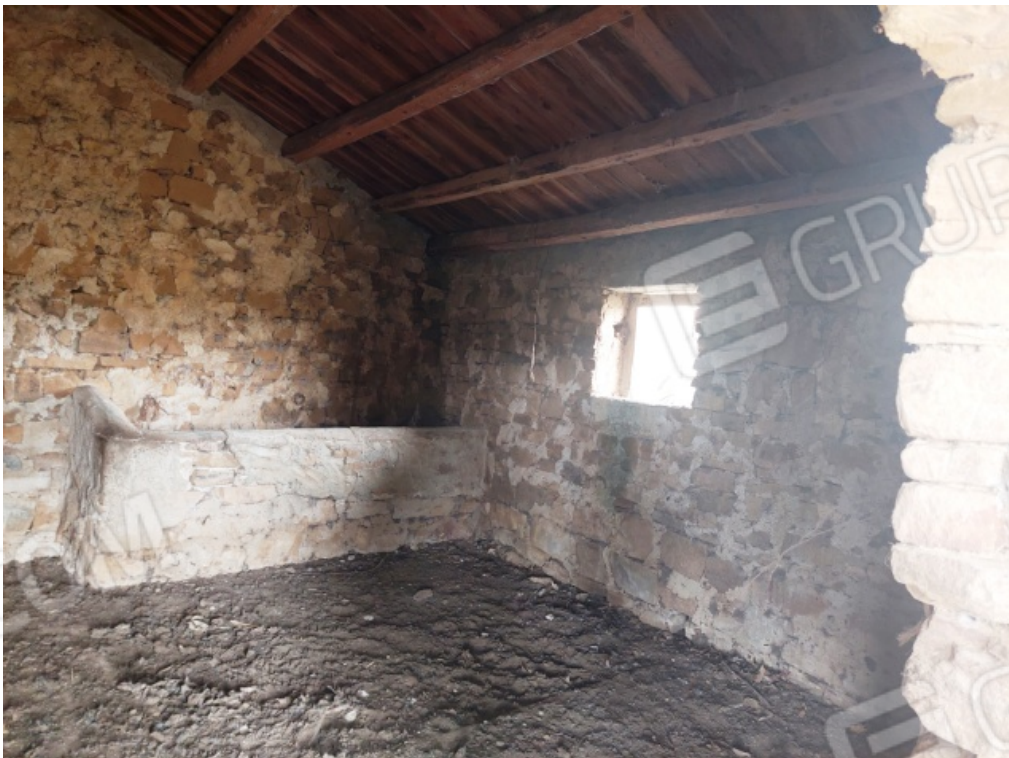
Foto 18 – Manufatto su p.lla 173
