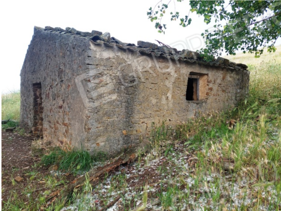
Foto 19 – Manufatto su p.lla 173
