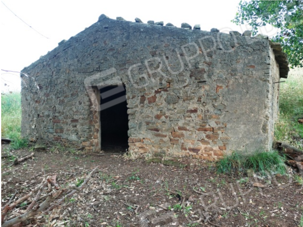
Foto 17 – Manufatto su p.lla 173
