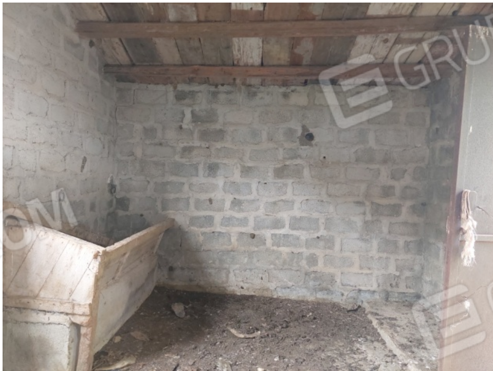
Foto 24 - Manufatto su p.lla 175
