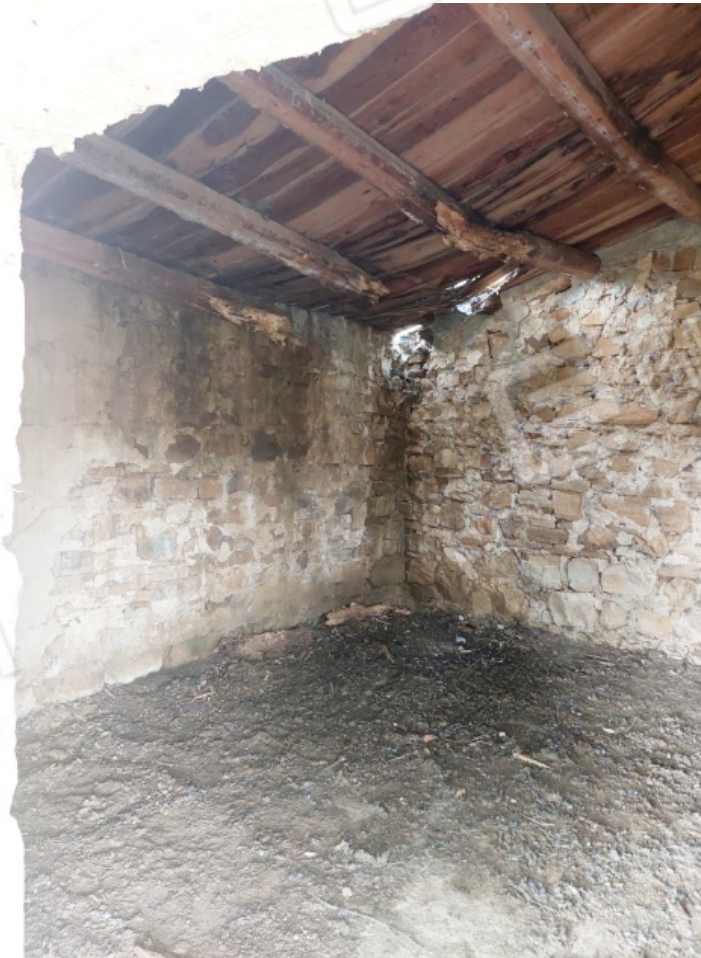
Foto 20 – Manufatto su p.lla 173
