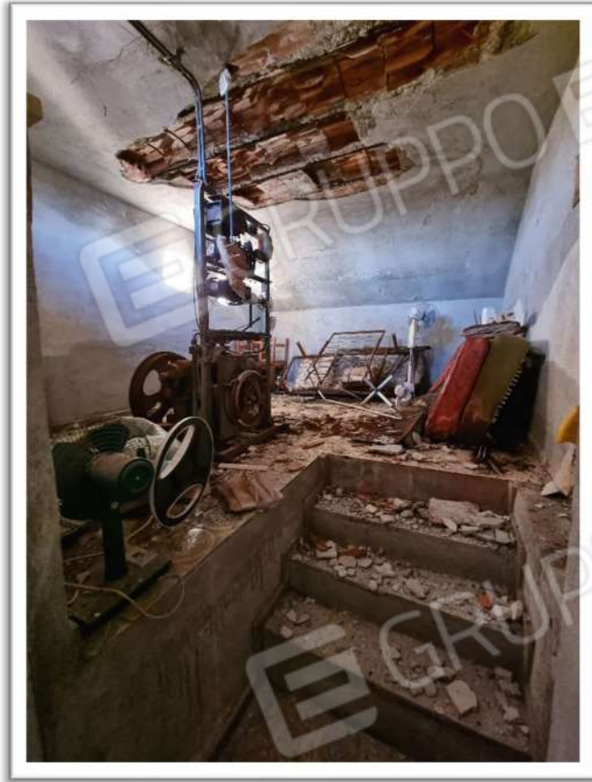
Foto 16 – Locale tecnico motore ascensore – piano 4°
