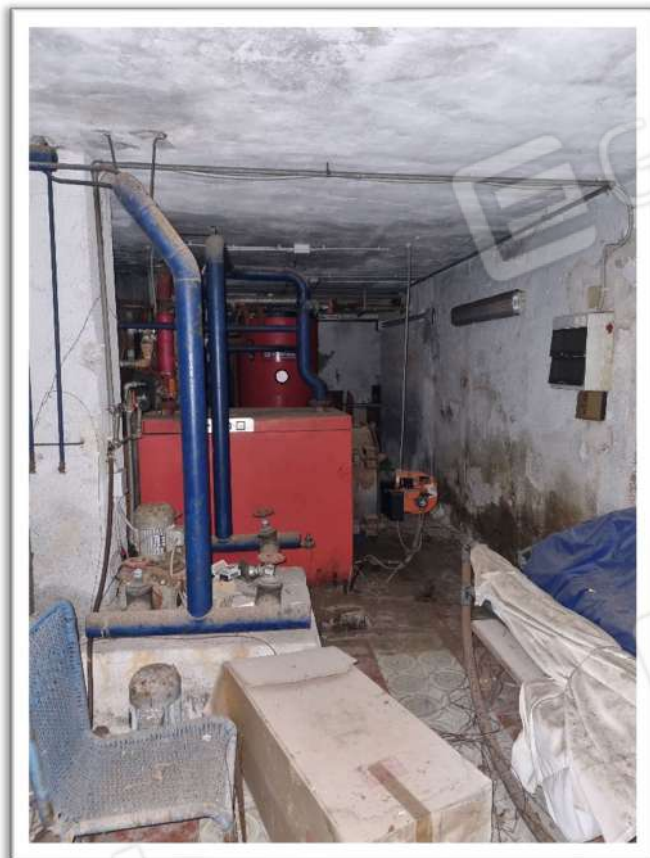
Foto 17 – Locale caldaia - piano 1° sottostrada
