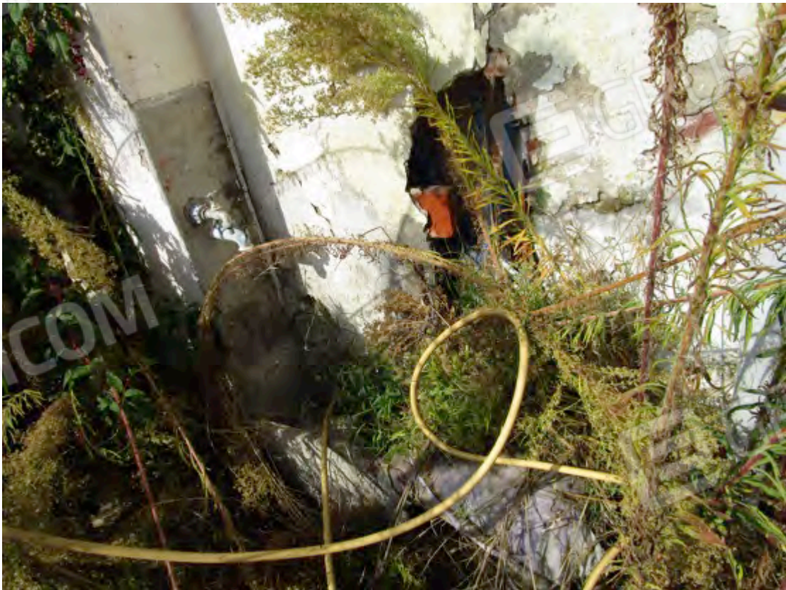
80. Tubature dell'acqua esposte sul lato sud del fabbricato.
