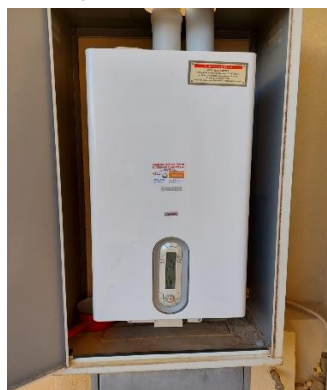
Foto n° 16 Caldaia a metano
