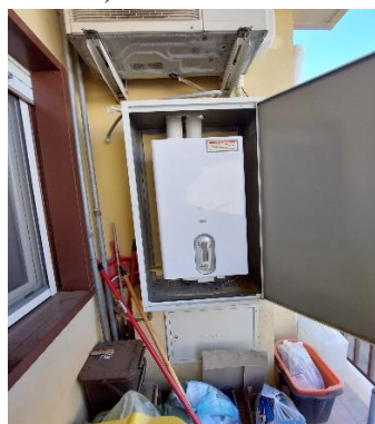
Foto n° 16 Caldaia a metano
