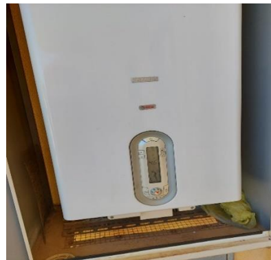
Foto n° 16 Caldaia a metano
