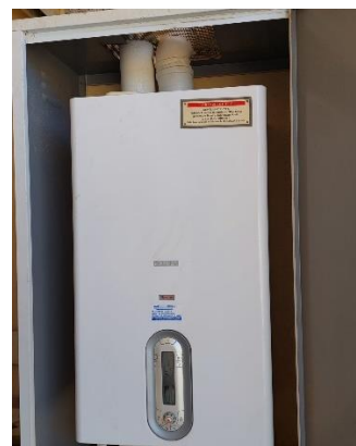
Foto n° 16 Caldaia a metano
