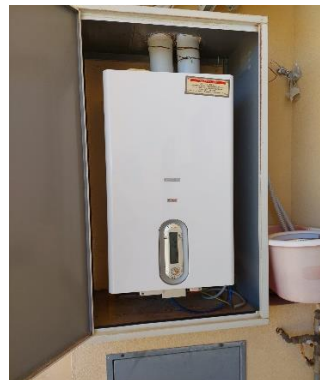
Foto n° 16 Caldaia a metano
