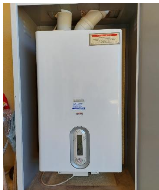
Foto n° 16 Caldaia a metano
