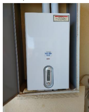
Foto n° 16 Caldaia a metano
