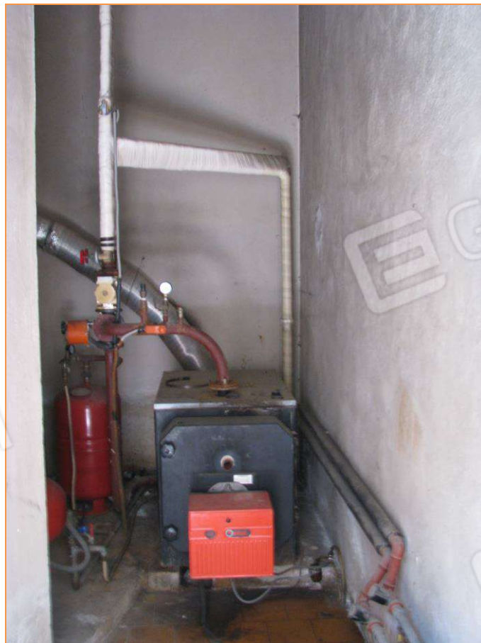
Foto 8 - Vista Locale Caldaia
