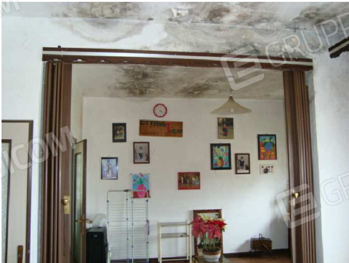
Foto n. 12: Foto interna soggiorno - pranzo con evidenti macchie sul soffitto per infiltrazioni di acqua dal terrazzo
