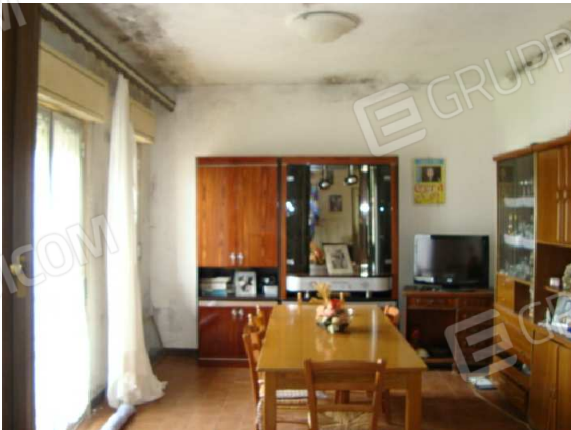
Foto n. 14: Foto interna soggiorno - pranzo con evidenti macchie sul soffitto per infiltrazioni di acqua dal terrazzo
