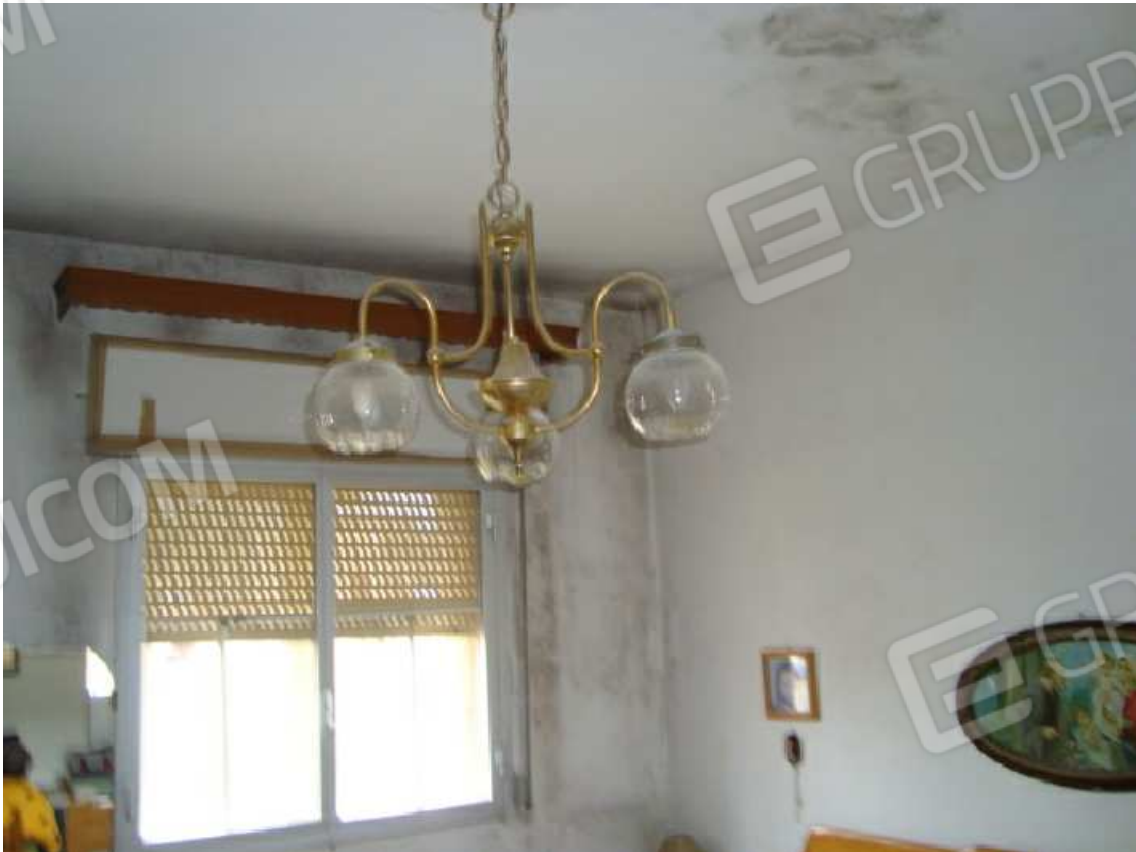
Foto n. 16: Foto interna camera da letto con evidenti macchie sul soffitto per infiltrazioni di acqua dal terrazzo
