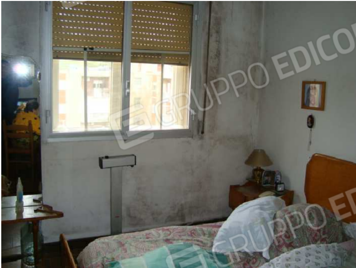
Foto n. 17: Foto interna camera da letto con evidenti macchie sulla parete esterna per infiltrazioni di acqua dal prospetto esterno
