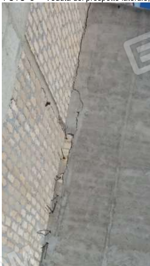
FOTO 4 - Particolare della lesione
