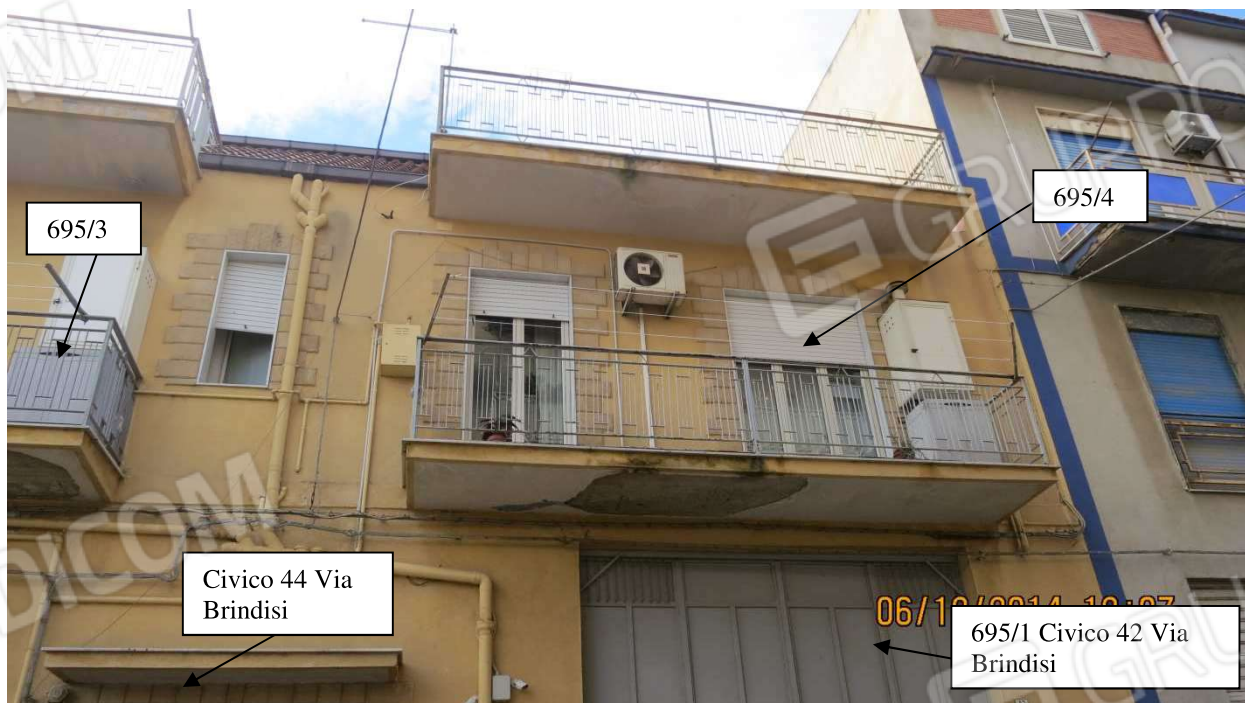
FOTO 2: Altro dettaglio sul fabbricato a due elevazioni fuori terra con scorcio della saracinesca di ingresso al magazzino di cui alla Part.IIa 695/1 in corrispondenza del civico n. 42 e sovrastante balcone di cui alla Part.IIa 695/4.
