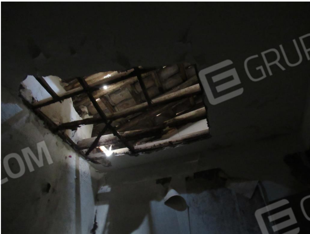
Foto n° 12 – Altra zona soffitto ammalorato –
