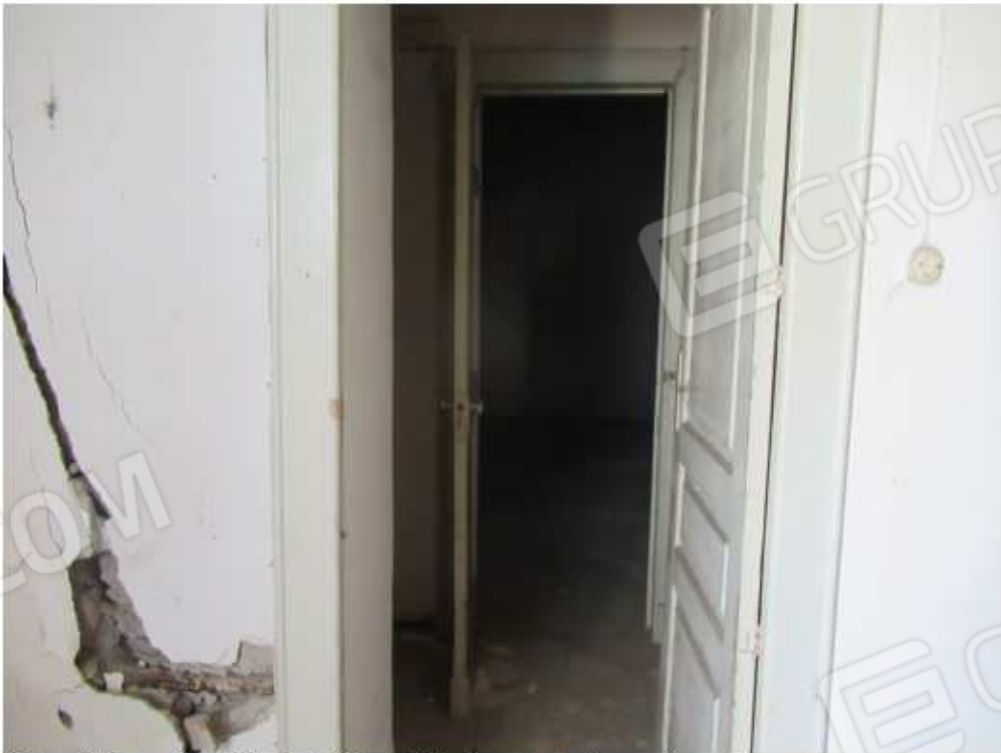
Foto n ° 10 - Condizioni dell'immobile riscontrate al sopralluogo -
