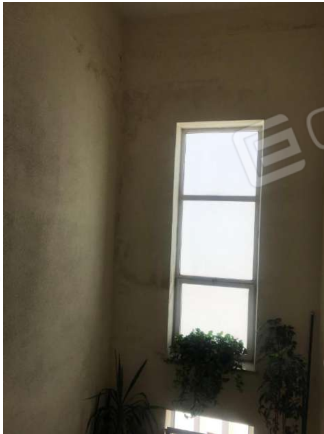
Foto n.16 Particolare ammaloramenti vano scala
