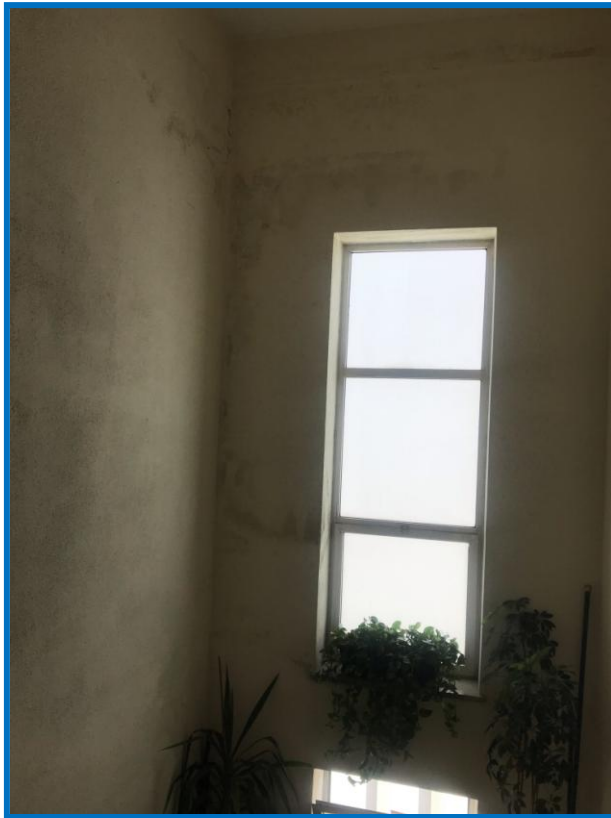
PARTICOLARE AMMALORAMENTI PRESENTI NEL VANO SCALA
