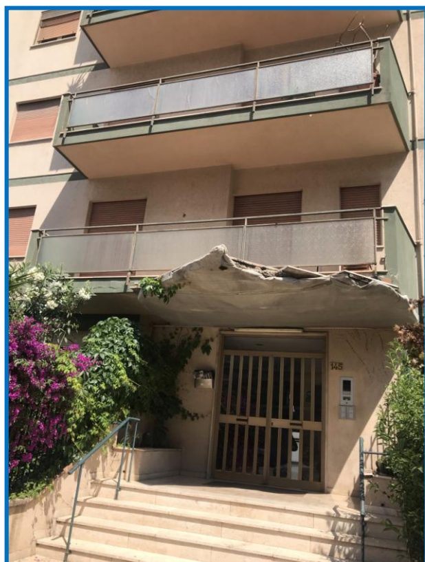
INGRESSO CONDOMINIALE CON PENSILINA MESSA IN SICUREZZA
