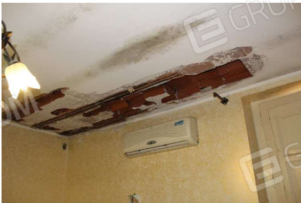
Foto n. 30 – Camera al piano secondo: intradosso solaio di copertura del terrazzo sovrastante.
