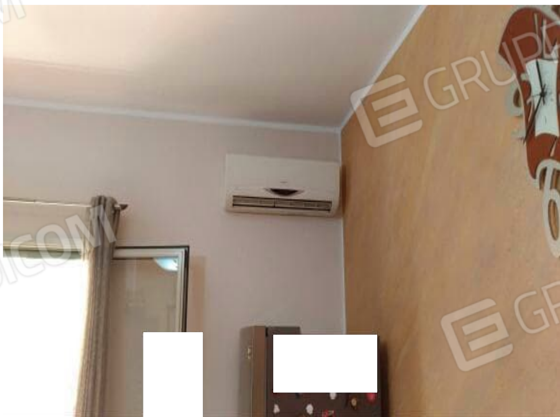
FOTO 20- Pompe di calore
