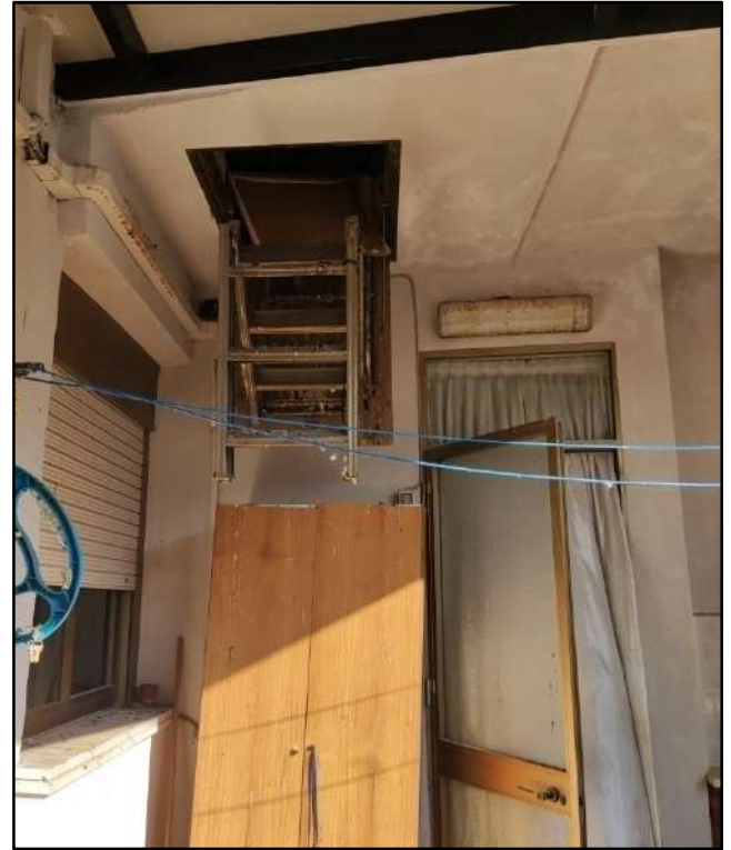
Scala retrattile di accesso al sottotetto
