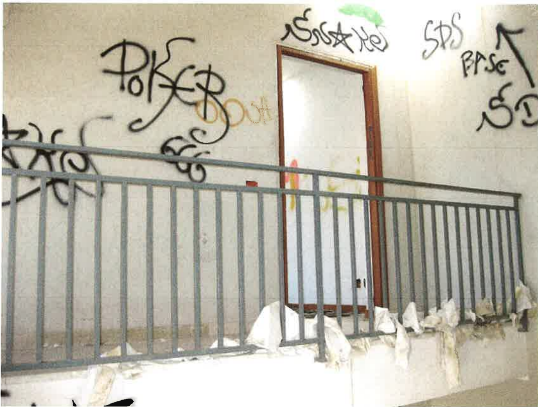
Foto 17: lo sbarco della scala condominiale al secondo piano; al centro il vano d'ingresso all'unità immobiliare destinata ad ufficio, identificata, nel foglio 12 di Bagheria, dalla particella 959 sub. 11
