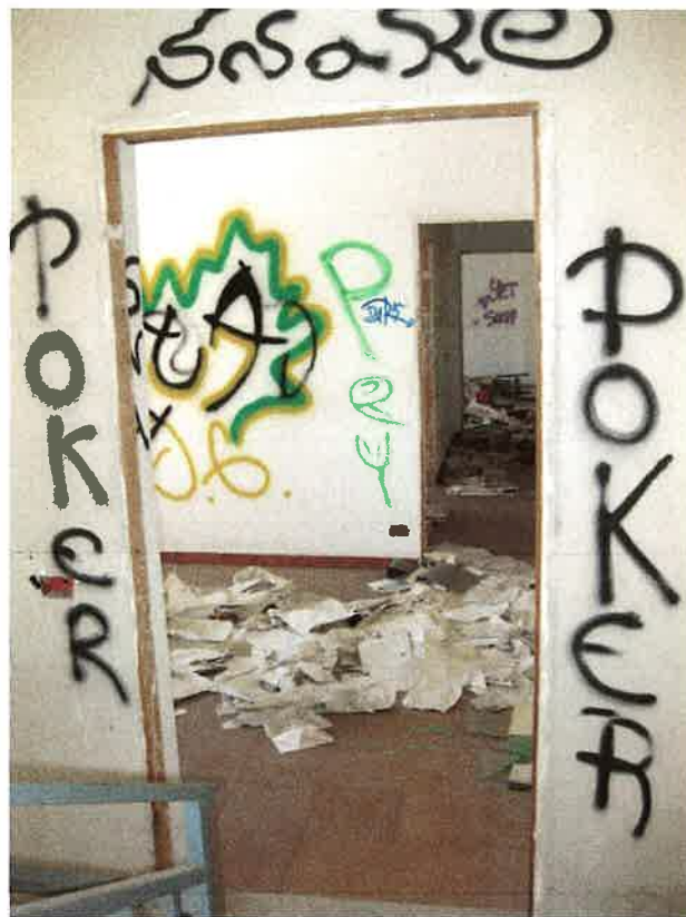
Foto 6: il vano d'ingresso all'unità immobiliare destinata ad ufficio, identificata, nel foglio 12 di Bagheria, dalla particella 959 sub. 7
