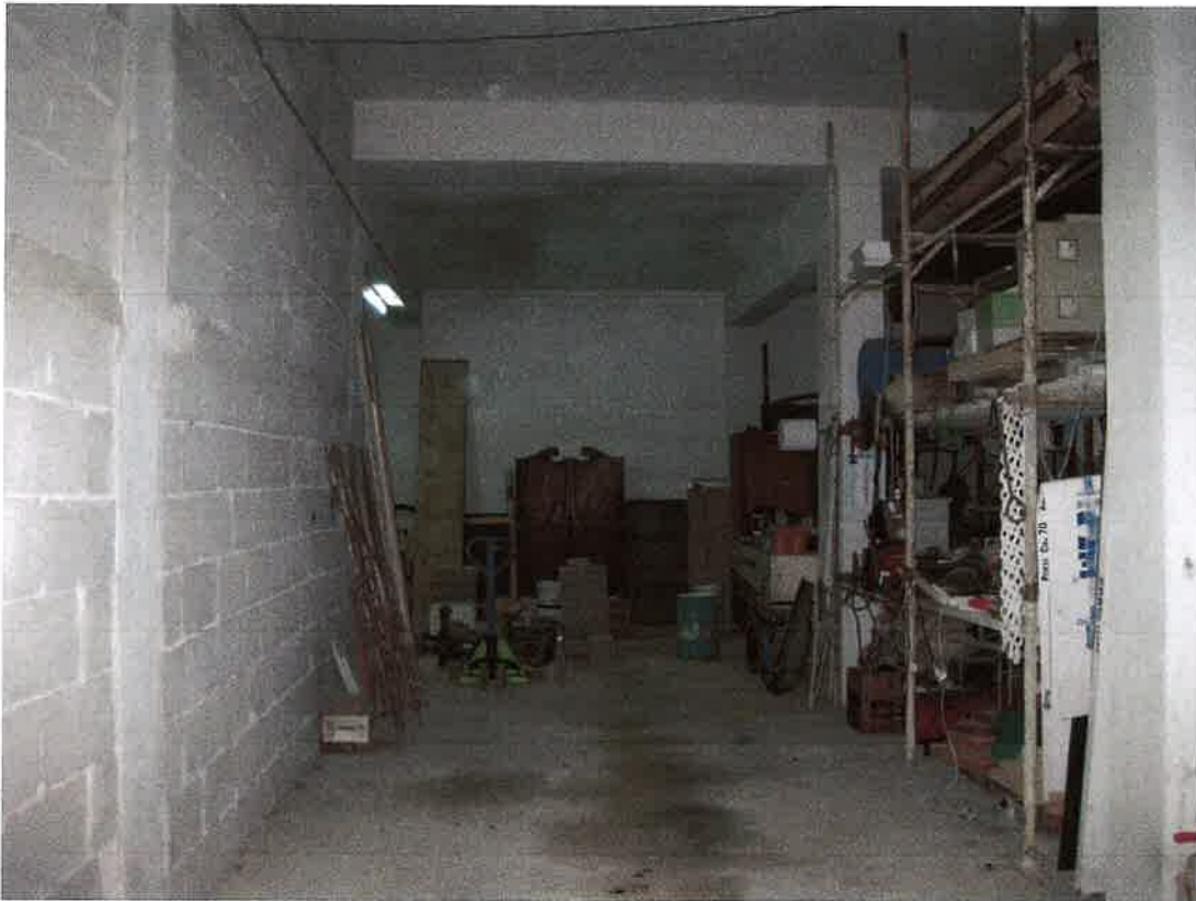
Foto 51: il locale box identificato, nel foglio 7 di Bagheria, dalla particella 1642 sub. 41; in difformità a quanto rappresentato catastalmente, manca la muratura di separazione dal limitrofo locale identificato dalla particella 1642 sub. 40
