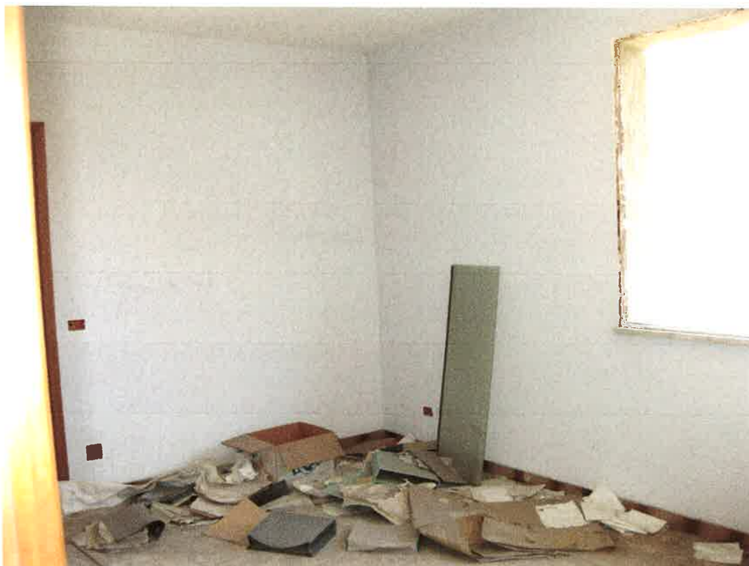
Foto 23: il primo ambiente dell'unità immobiliare destinata ad ufficio, identificata, nel foglio 12 di Bagheria, dalla particella 959 sub. 13, con affaccio sulla Via Teocrito
