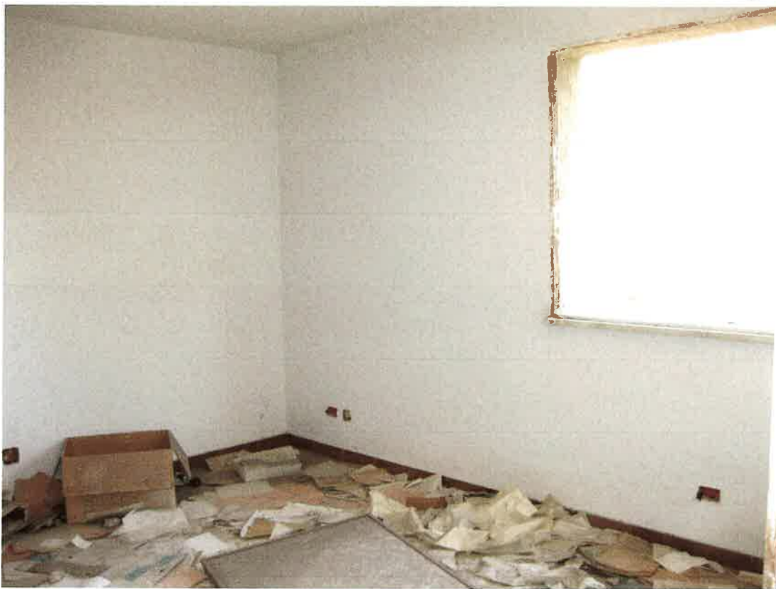
Foto 14: altra inquadratura del primo ambiente dell'unità immobiliare destinata ad ufficio, ubicata al primo piano, identificata, nel foglio 12 di Bagheria, dalla particella 959 sub. 9, con affaccio sulla via Teocrito
