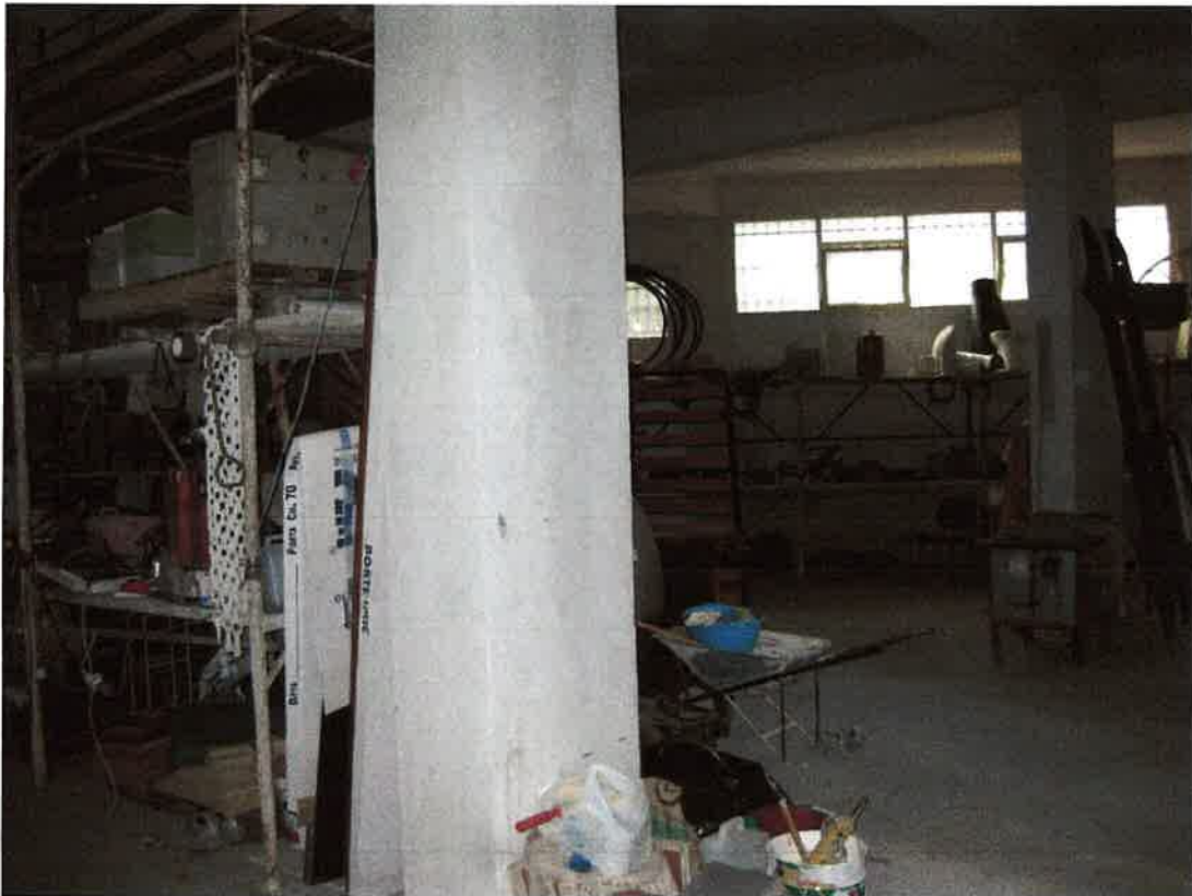
Foto 50: il locale box identificato, nel foglio 7 di Bagheria, dalla particella 1642 sub. 40; in difformità a quanto rappresentato catastalmente, manca la muratura di separazione dal limitrofo locale identificato dalla particella 1642 sub. 39 e quella di separazione dal limitrofo locale identificato dalla particella 1642 sub. 41
