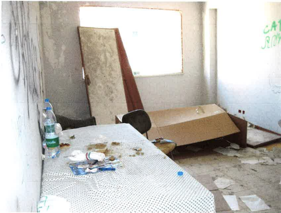
Foto 21: il terzo ambiente dell'unità immobiliare destinata ad ufficio, identificata, nel foglio 12 di Bagheria, dalla particella 959 sub. 11, con affaccio sulla Via Teocrito
