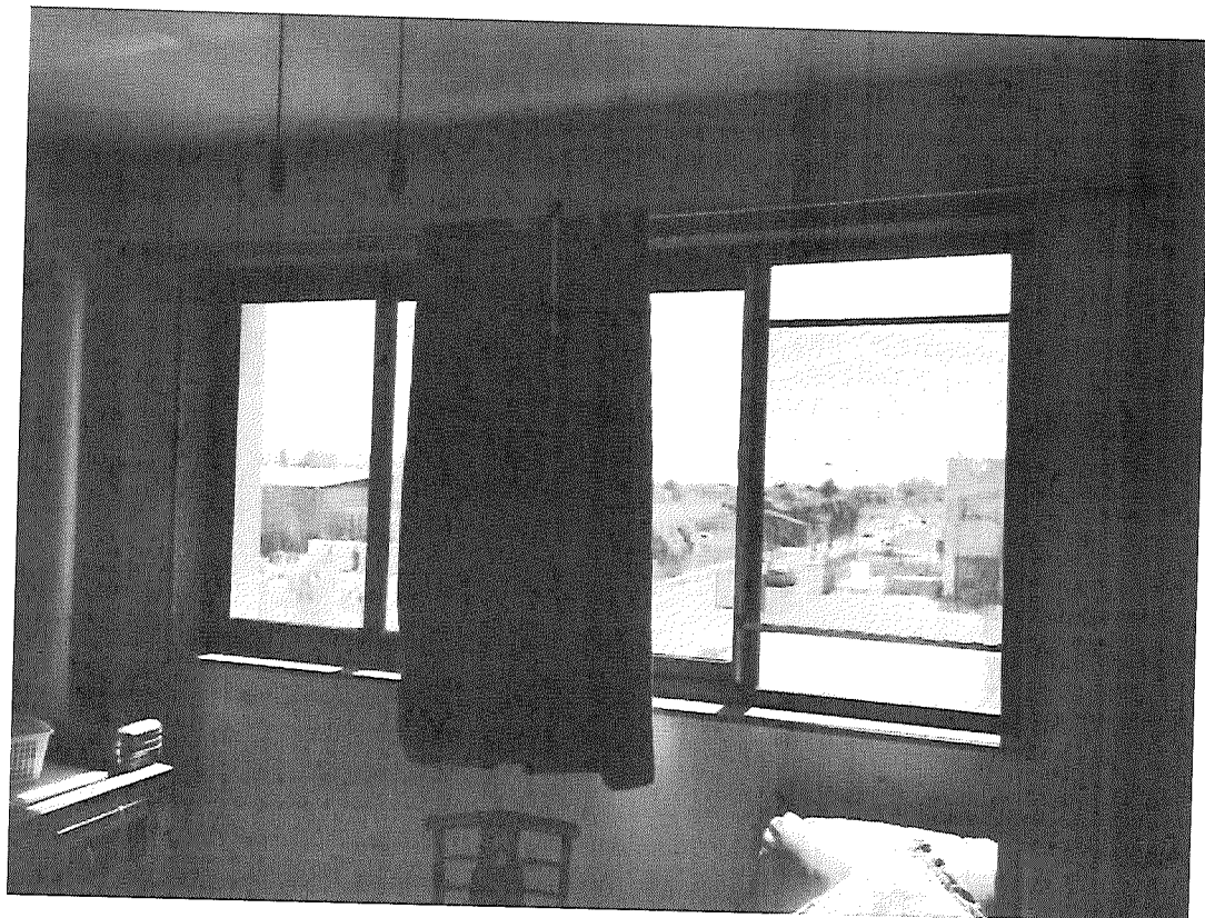
Foto 12 – infissi esterni piano uffici
