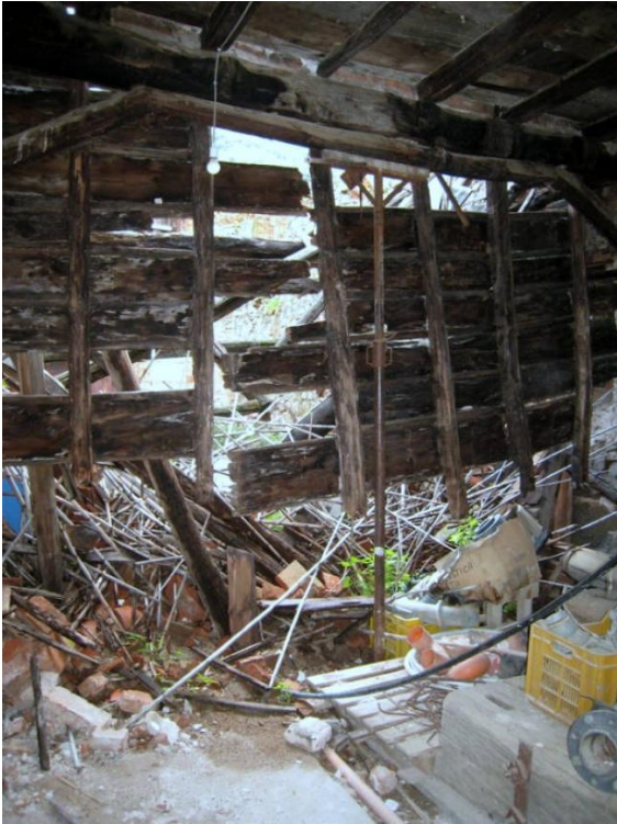
Foto n. 30. Il sub 4, unità collabente del P.T., corpo "B".
