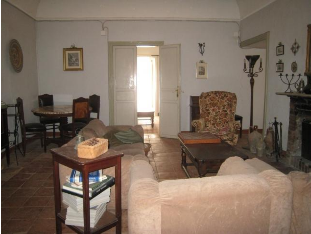
Foto n. 38. Altra visione del salotto. Il pavimento è in cattive condizioni.
