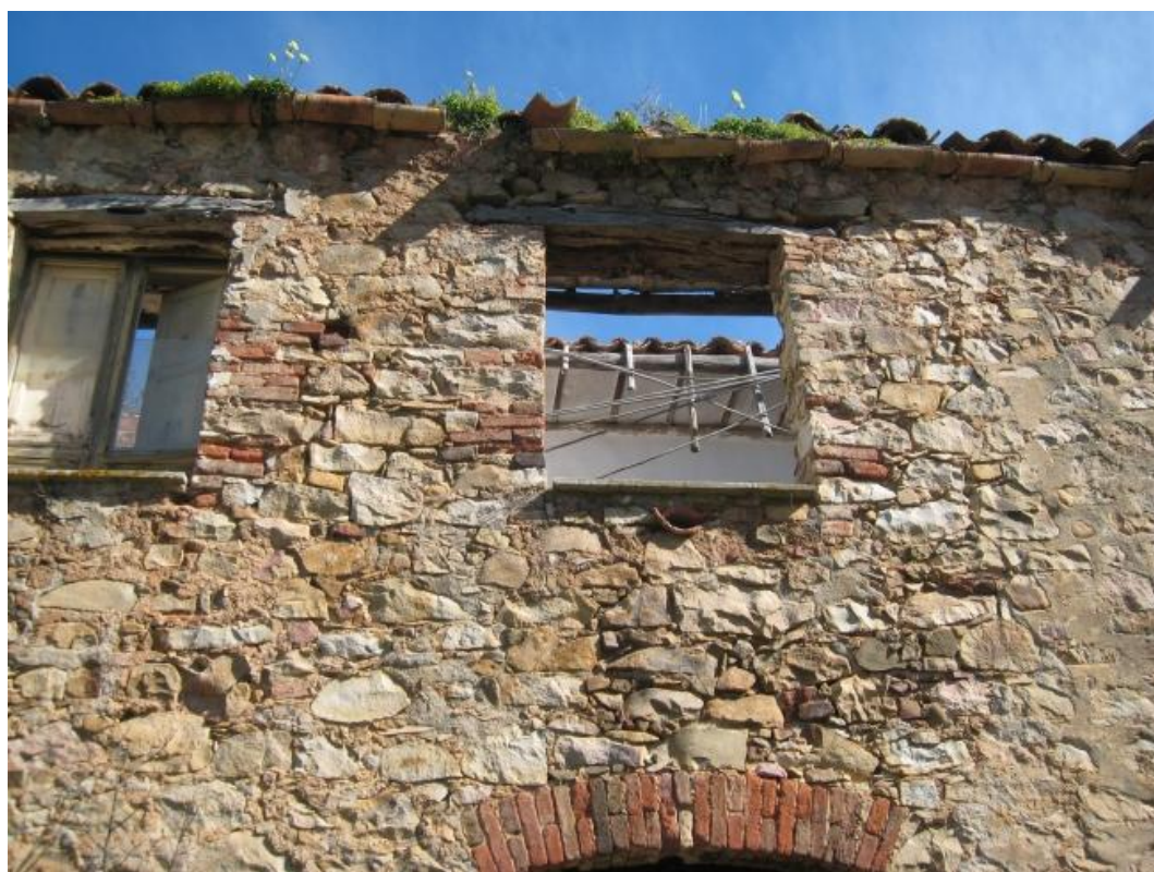
Foto n. 69. Condizioni di muratura ed infissi.
