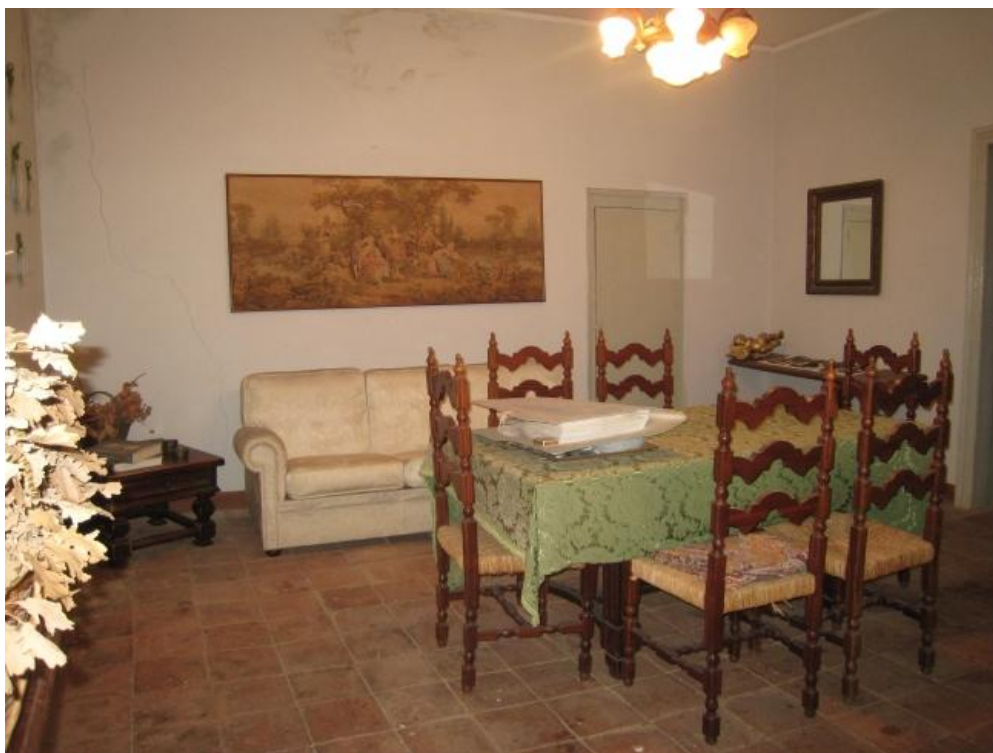
Foto n. 36. Altra inquadratura della sala da pranzo. Sono visibili macchie di umidità e lesione alla muratura.
