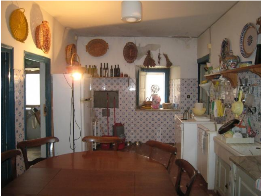
Foto n. 40. Sempre la cucina. Tracce di umidità al soffitto ed impianto elettrico a vista.
