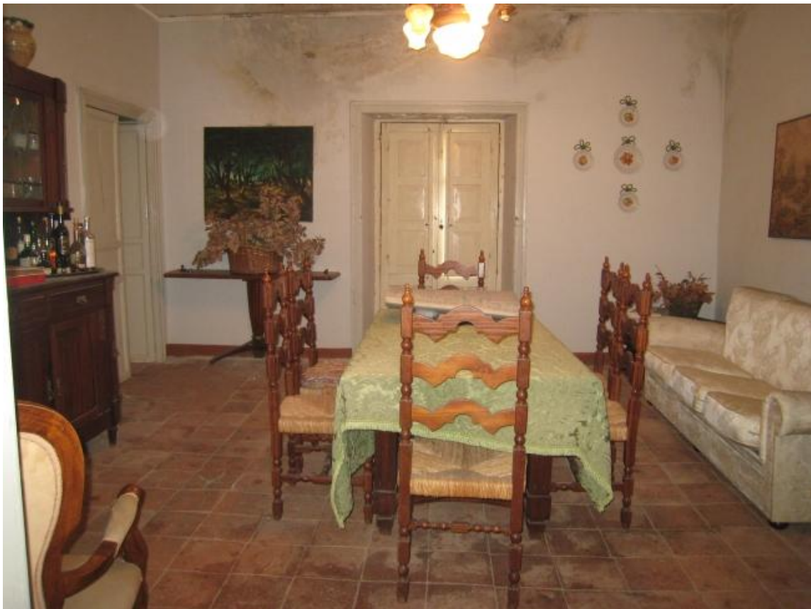
Foto n. 35. La sala da pranzo. Evidenti macchie di umidità sulla parete frontale.
