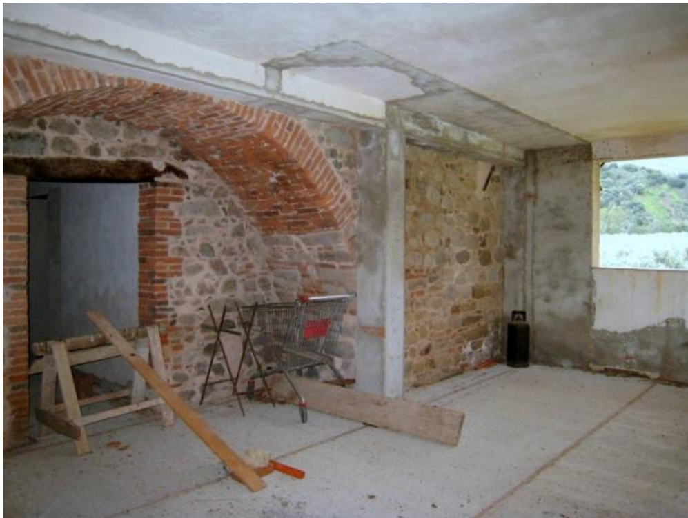
Foto n. 16. Ampliamento al piano terra del corpo "B" fatto abusivamente.
