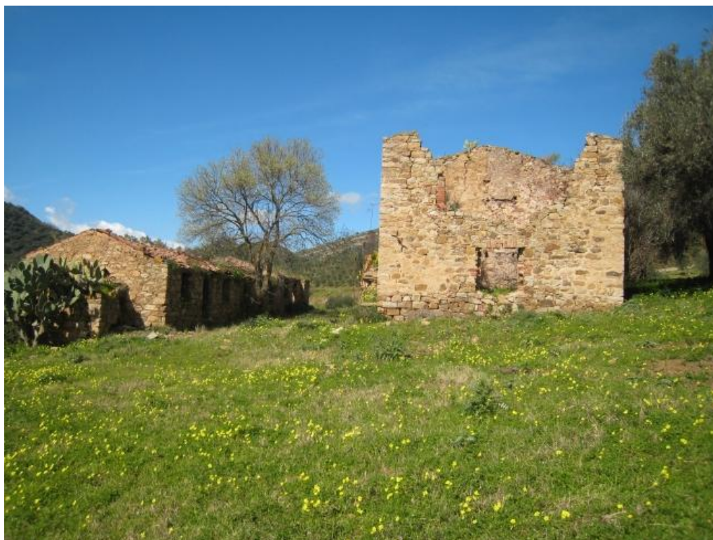
Foto n. 71. Una porzione di edificio a due piani è collassata.
