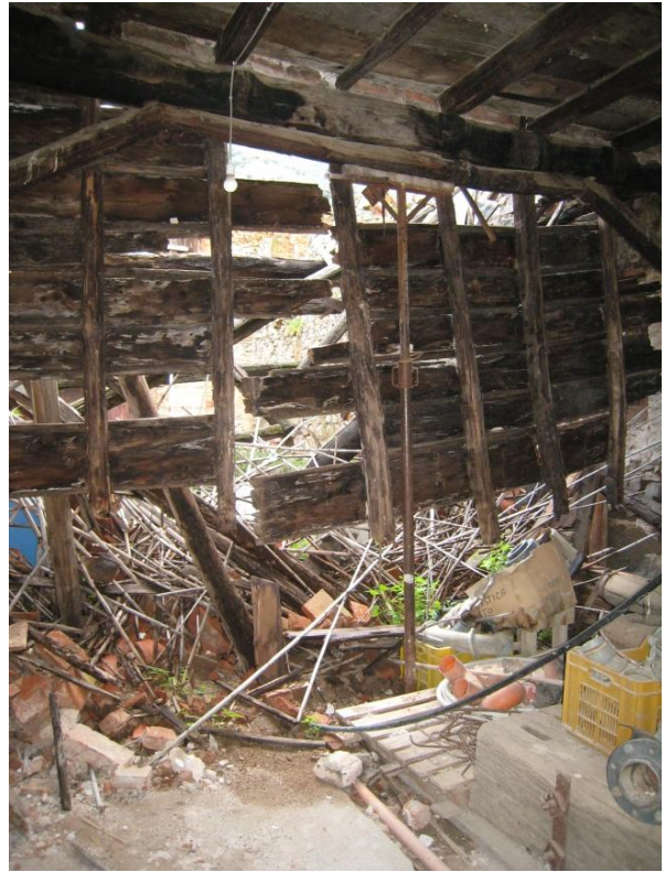
Foto n. 50. Piano terra edificio "B". Unità collabente distinta con il sub 4.
