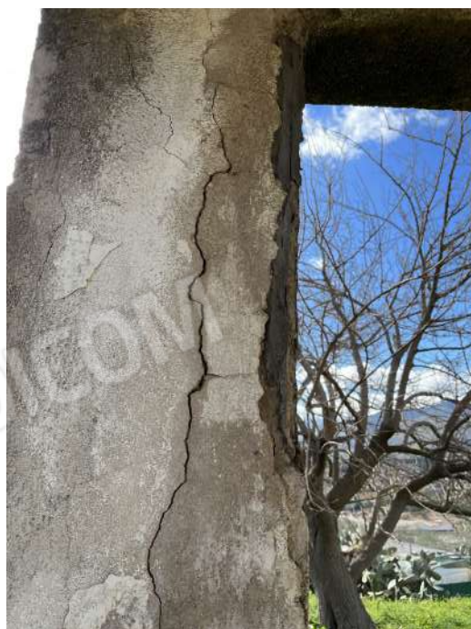
Foto 11 - Particolare della lesione
