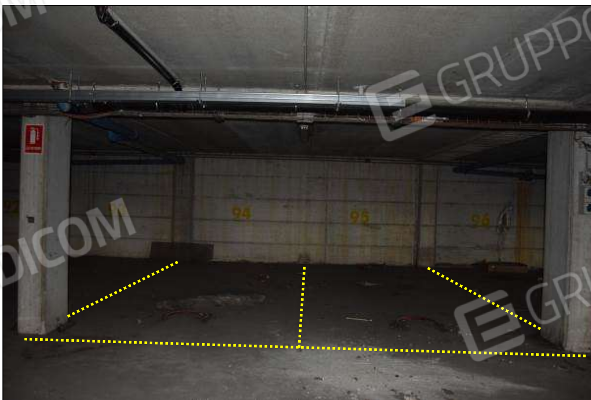
FOTO 8 – SUB 81 (POSTO 94) / SUB 82 (POSTO 95)
