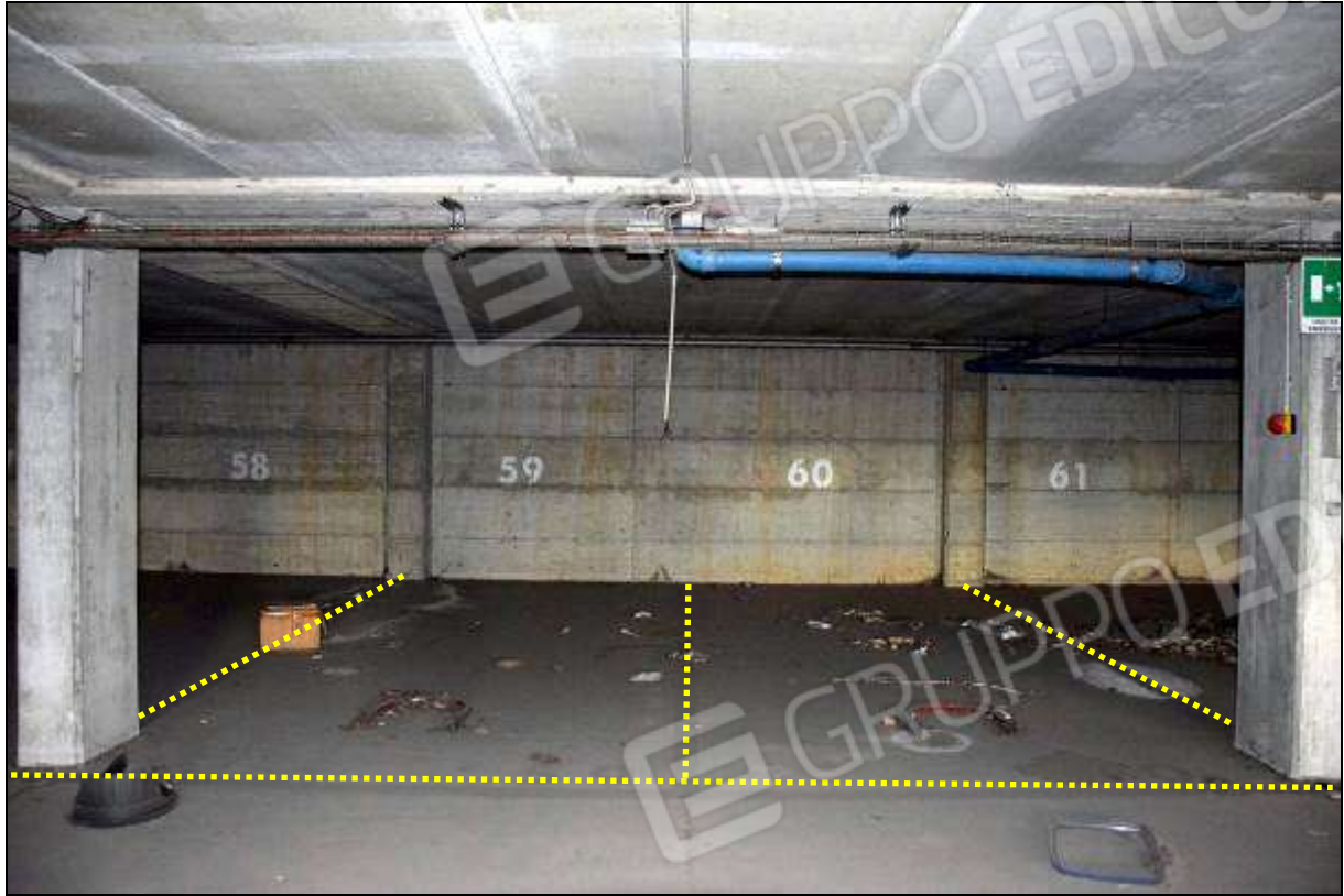
FOTO 1 – SUB 63 (POSTO 59) / SUB 64 (POSTO 60)
