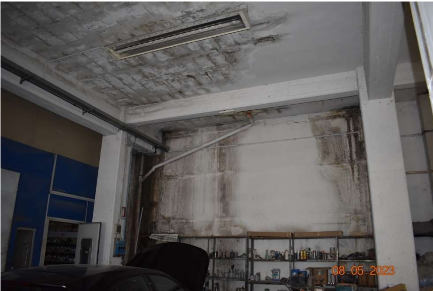
Foto 16 Zona interessata dalle infiltrazioni della copertura zona sud-est
