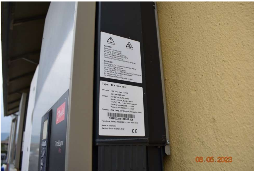
Foto 29 Etichetta inverter impianto FV (corpo C)
