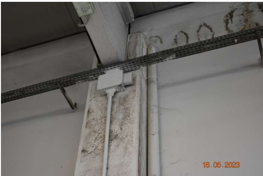
Foto 24 Vista del rivestimento ammalorato dei pilastri
