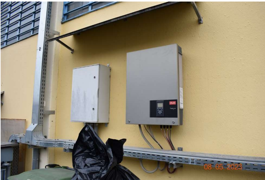
Foto 28 Vista degli inverter impianto FV (corpo C)
