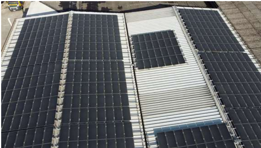
Foto 26 Vista della copertura con impianto FV (corpo C)
