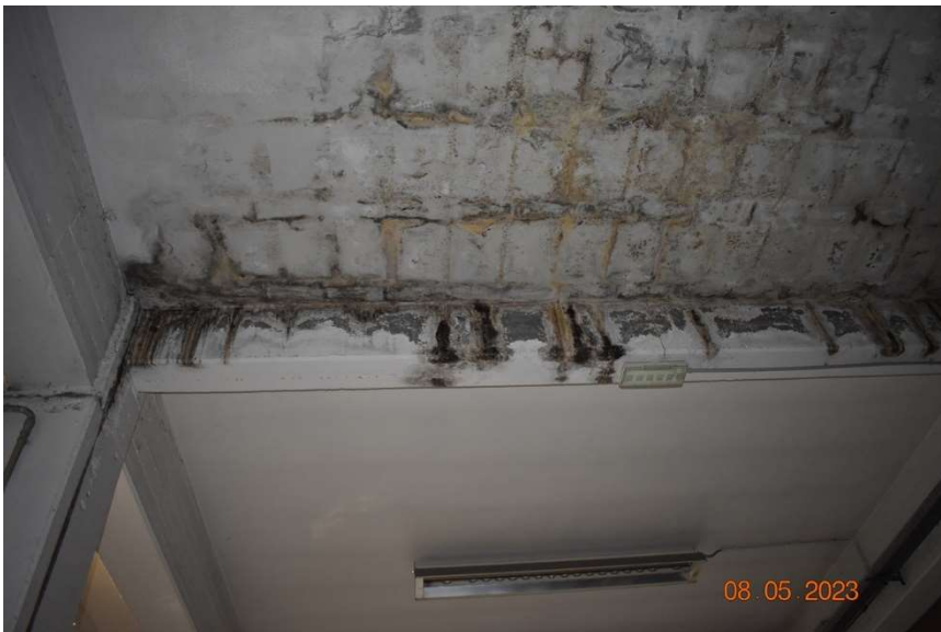
Foto 17 Zona interessata dalle infiltrazioni della copertura zona sud-est
