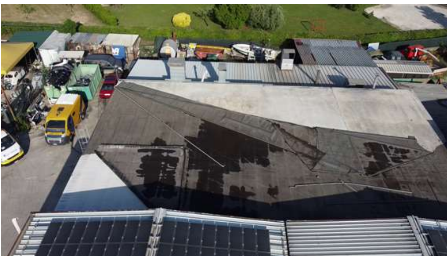
Foto 18 Vista della copertura del capannone e guaina deteriorata
