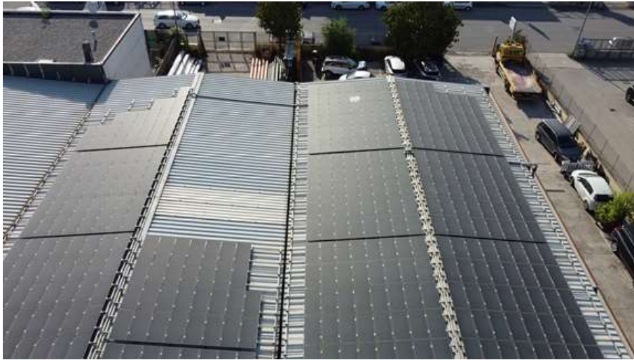
Foto 25 Vista della copertura con impianto FV (corpo C)
