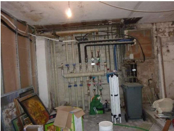
Particolare interno zona nord-est sub. 30 – centrale termica
