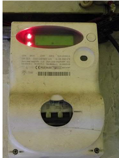
78 Contatore energia elettrica, posto al piano terra
