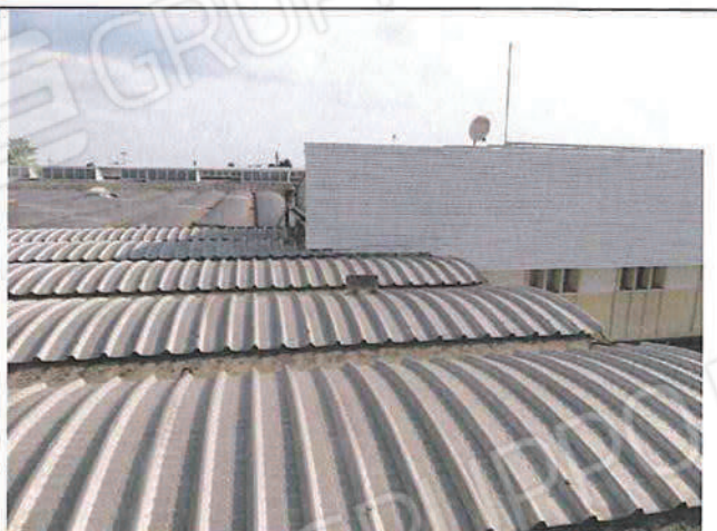
Foto n°202: Coperture sei capannoni sub 6
