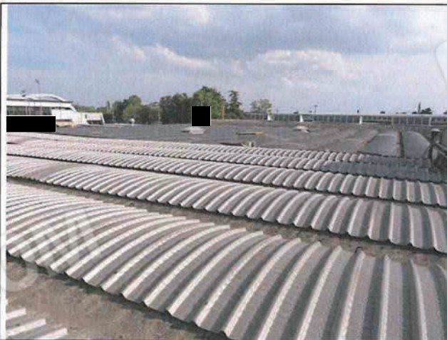
Foto n°201: Coperture sei capannoni sub 6
