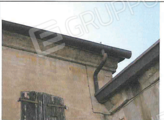
Foto n°230: Stato di conservazione precario
