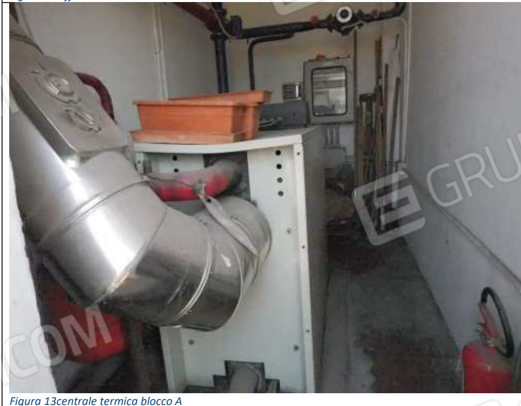
Figura 13 centrale termica blocco A
