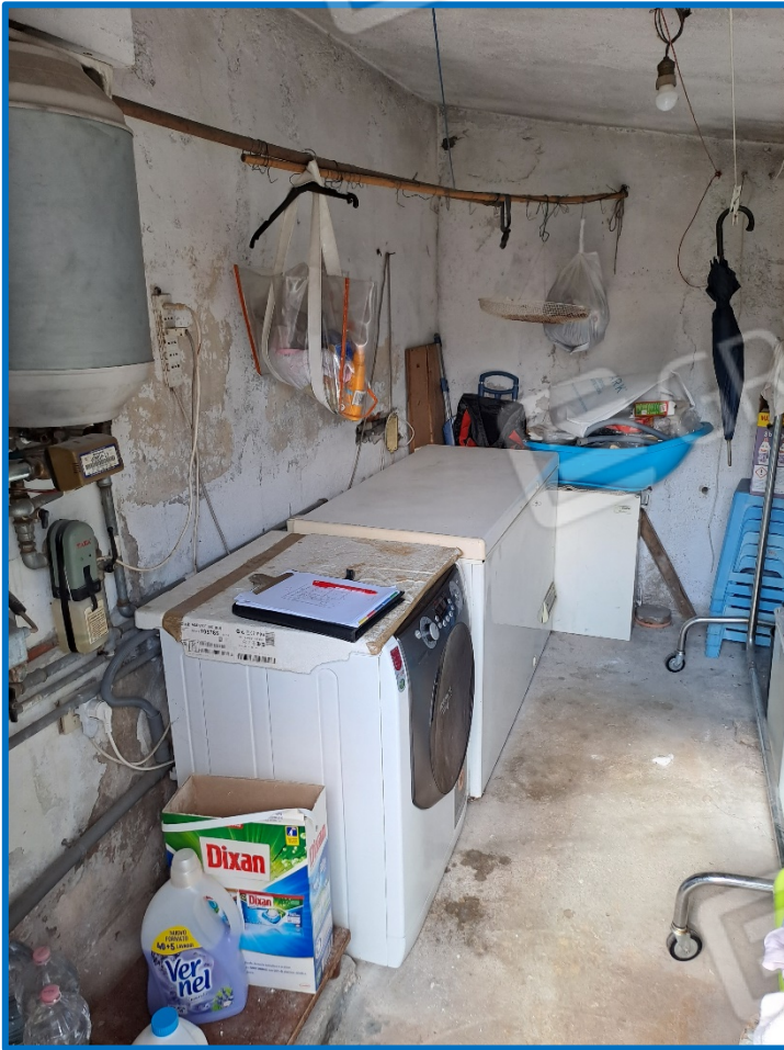
n° 7 - Interni centrale termica
