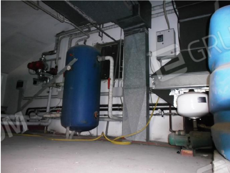
2 piano Sottotetto – centrale di climatizzazione e ventilazione
