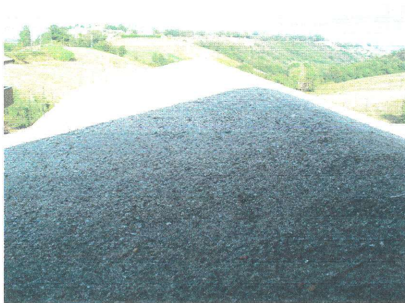
Figura 13 vista copertura: si nota la mancanza del manto di copertura
