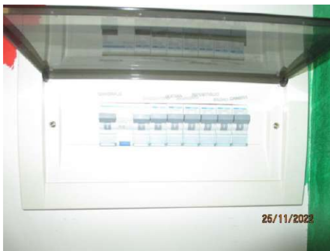
Foto 38. Particolare del quadro elettrico, posto all'interno dell'abitazione
