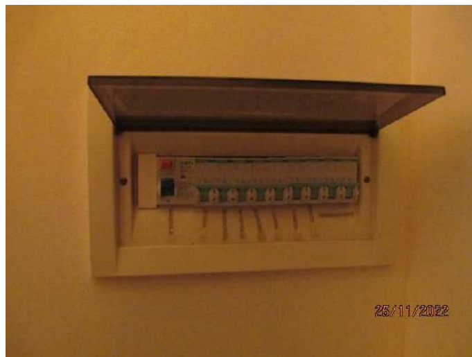
Foto 22. Particolare del quadro elettrico posto all'interno dell'abitazione
