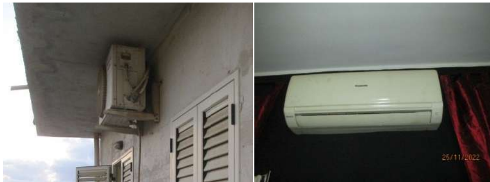
Foto 40. Particolare dell'impianto di condizionamento, a servizio dell'abitazione
