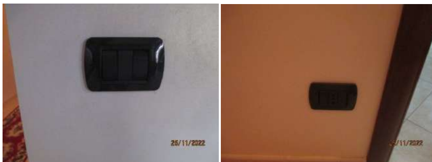
Foto 26. Particolari dell'impianto elettrico dell'immobile
