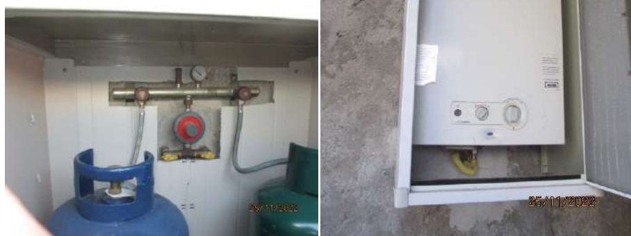
Foto 23. Particolari dell'impianto che alimenta l'acqua calda sanitaria, posto sul balcone
