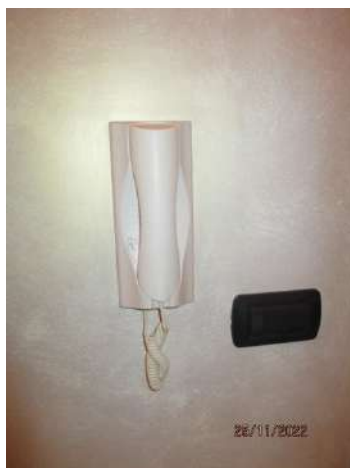
Foto 25. Particolare dell'impianto citofonico presente nell'immobile
