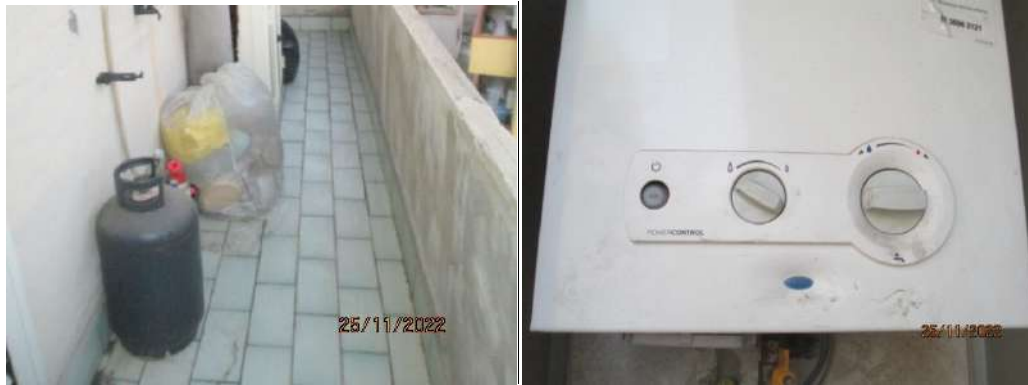
Foto 39. Particolari dell'impianto che alimenta l'acqua calda sanitaria, posto sul balcone dell'immobile
