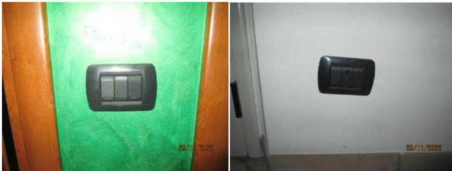
Foto 42. Particolari dell'impianto elettrico presente nell'immobile
