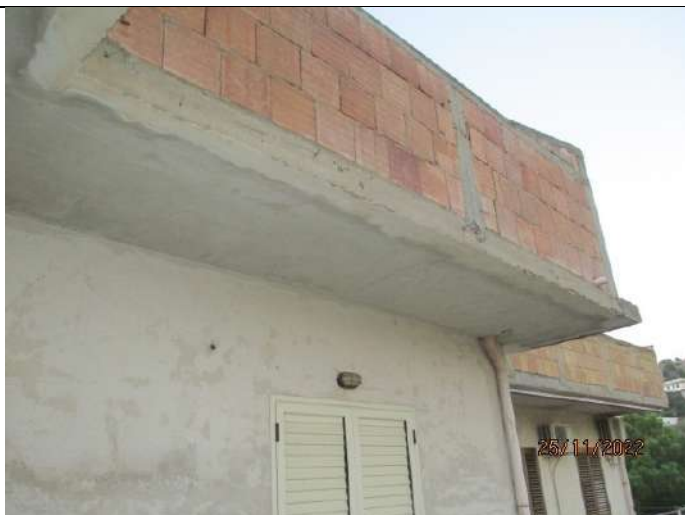
Foto 36. Particolare dei parapetti dei balconi in muratura, che risultano non rifiniti all'esterno
