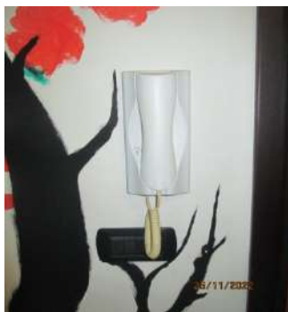
Foto 41. Particolare dell'impianto citofonico presente nell'immobile
