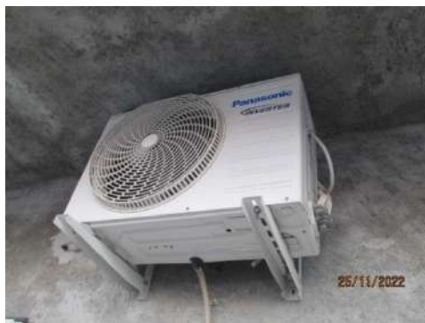
Foto 24. Particolare dell'impianto di condizionamento a servizio dell'abitazione
