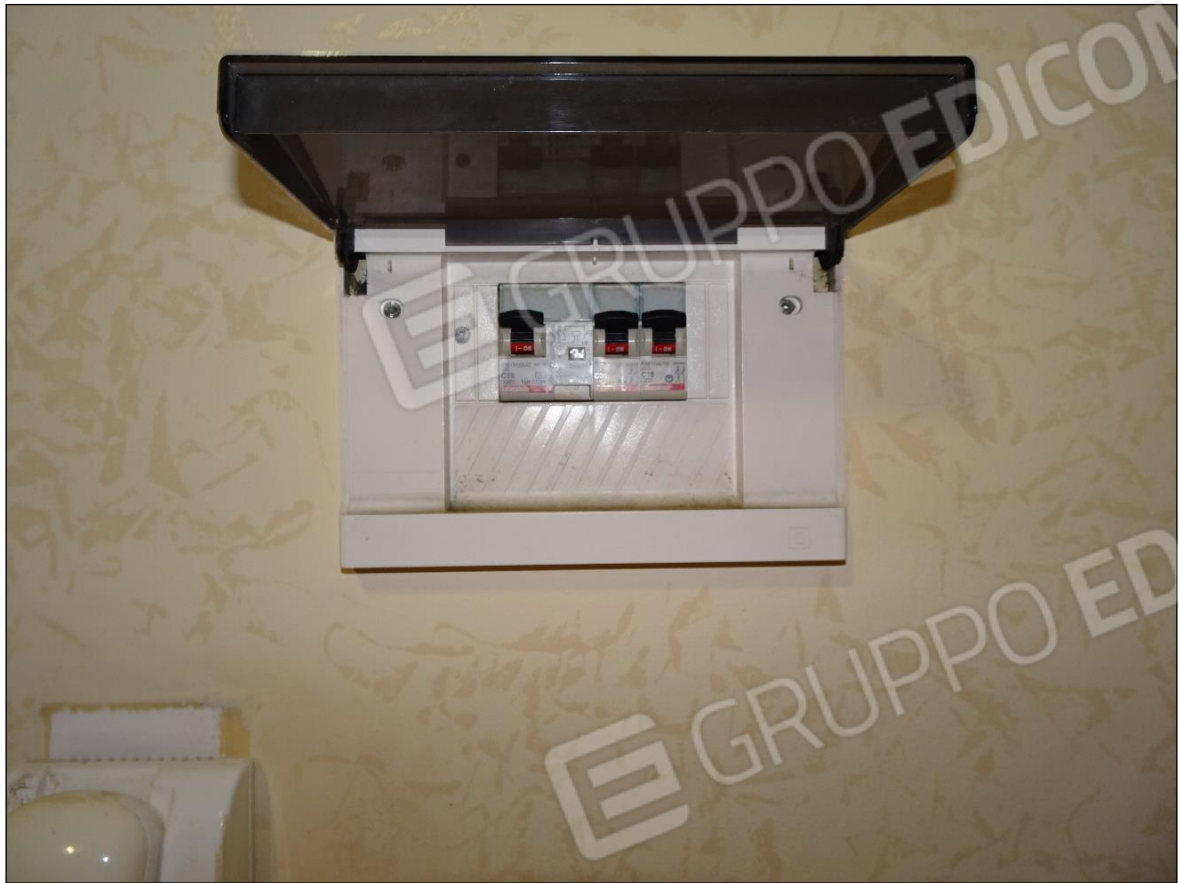
Foto 11: Vista particolare quadro elettrico appartamento
