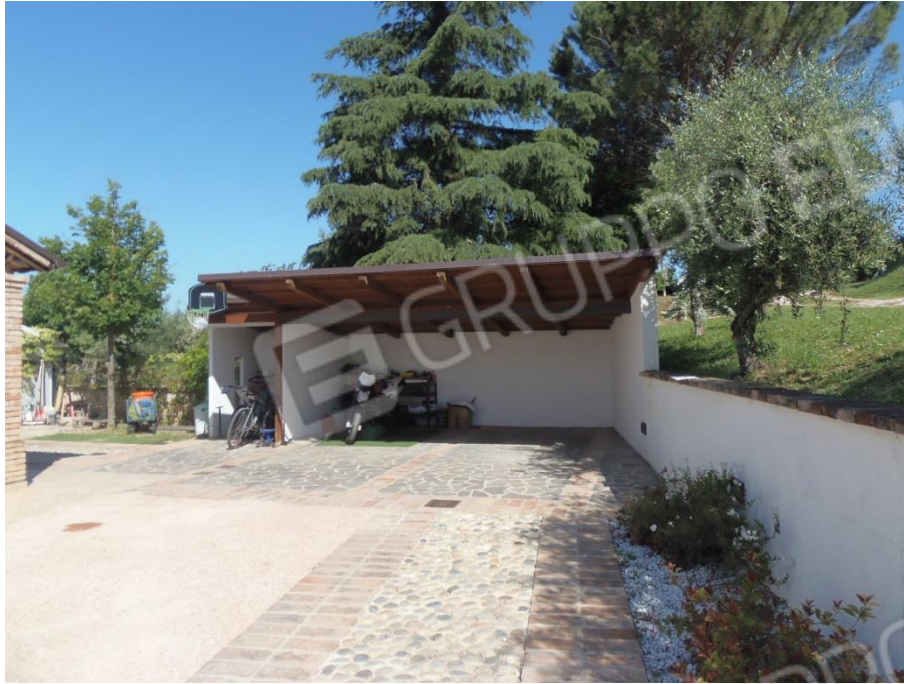
(Foto tettoia in legno, attualmente utilizzata ad uso ricovero mezzi, priva di titolo autorizzativo)
