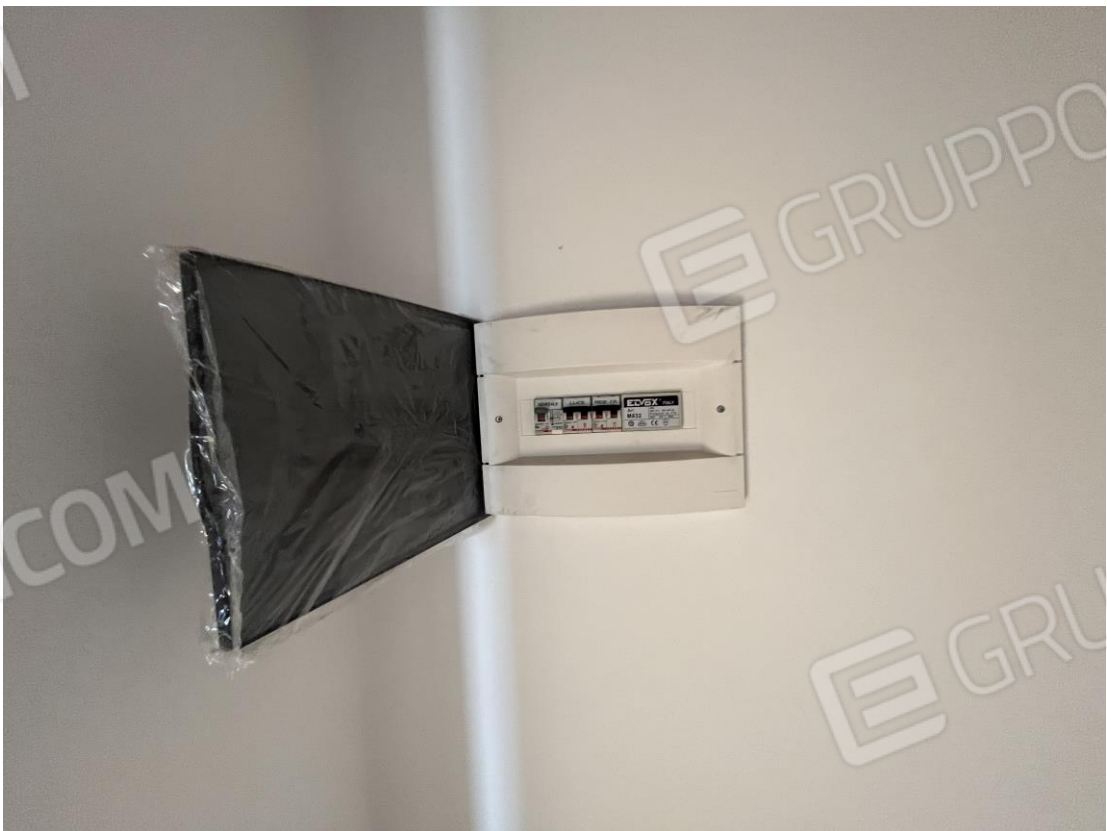
Quadro elettrico nel ripostiglio
