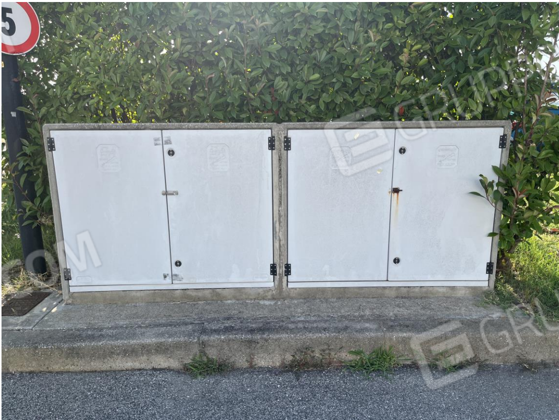
Contatore energia elettrica
