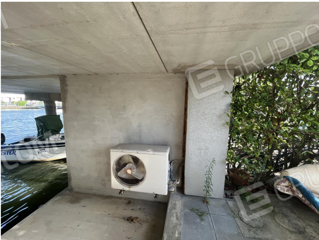
Pompa di calore
