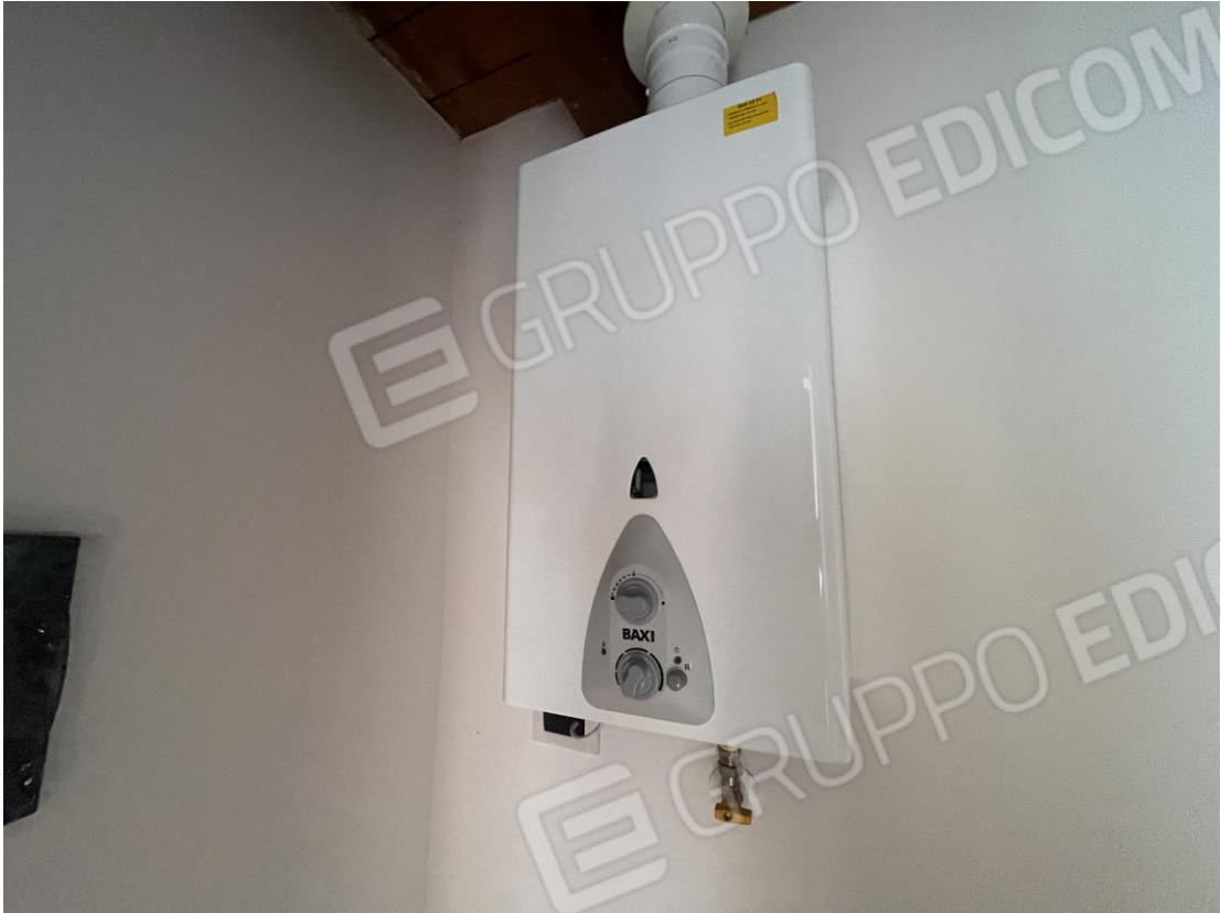
Caldaia posta nel ripostiglio
