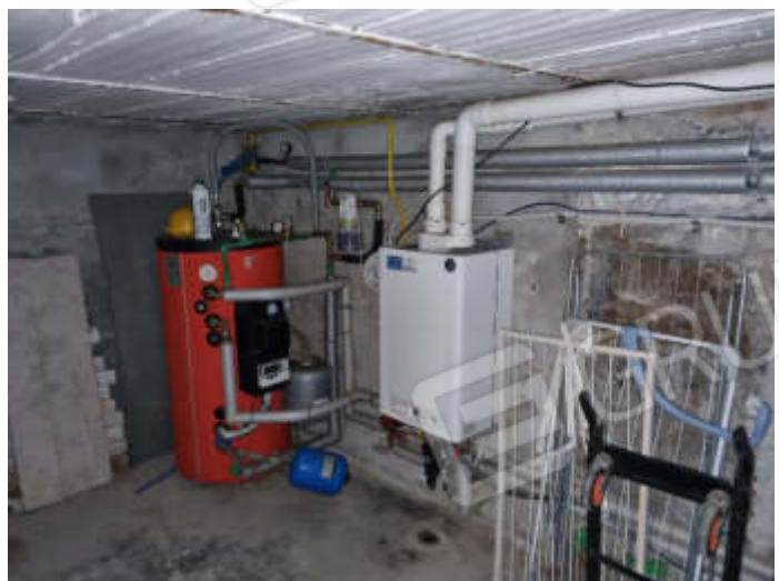
Foto 17- Cantina con centrale termica
