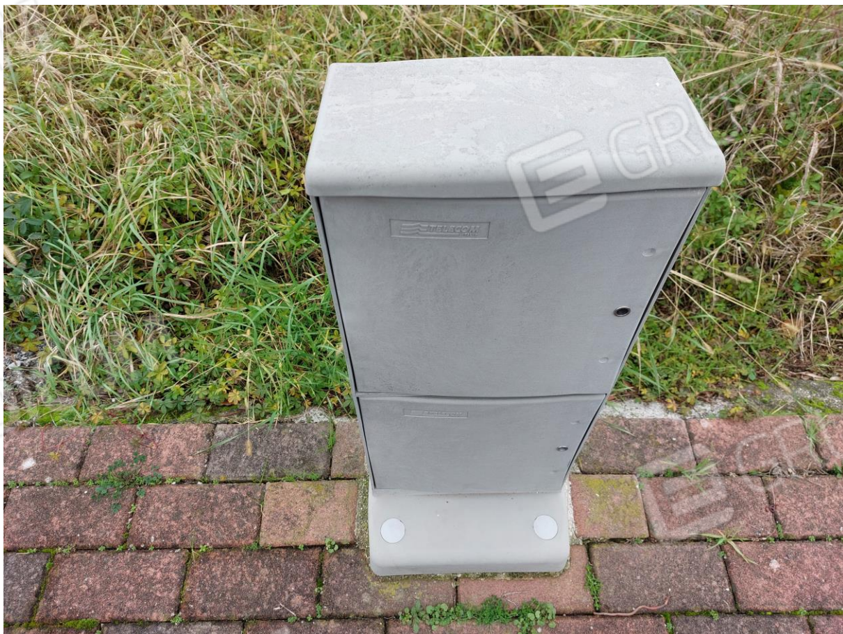
Foto n° 2 - Lotto 5 - Comune di San Michele al Tagliamento (VE) - Frazione Cesarolo - Foglio 38 m.le 949 - Particolare di uno degli armadietti per utenze di telecomunicazione presenti in prossimità dei terreni pignorati, nell'ambito dal Piano di Lottizzazione "Via G. Forgiarini".
