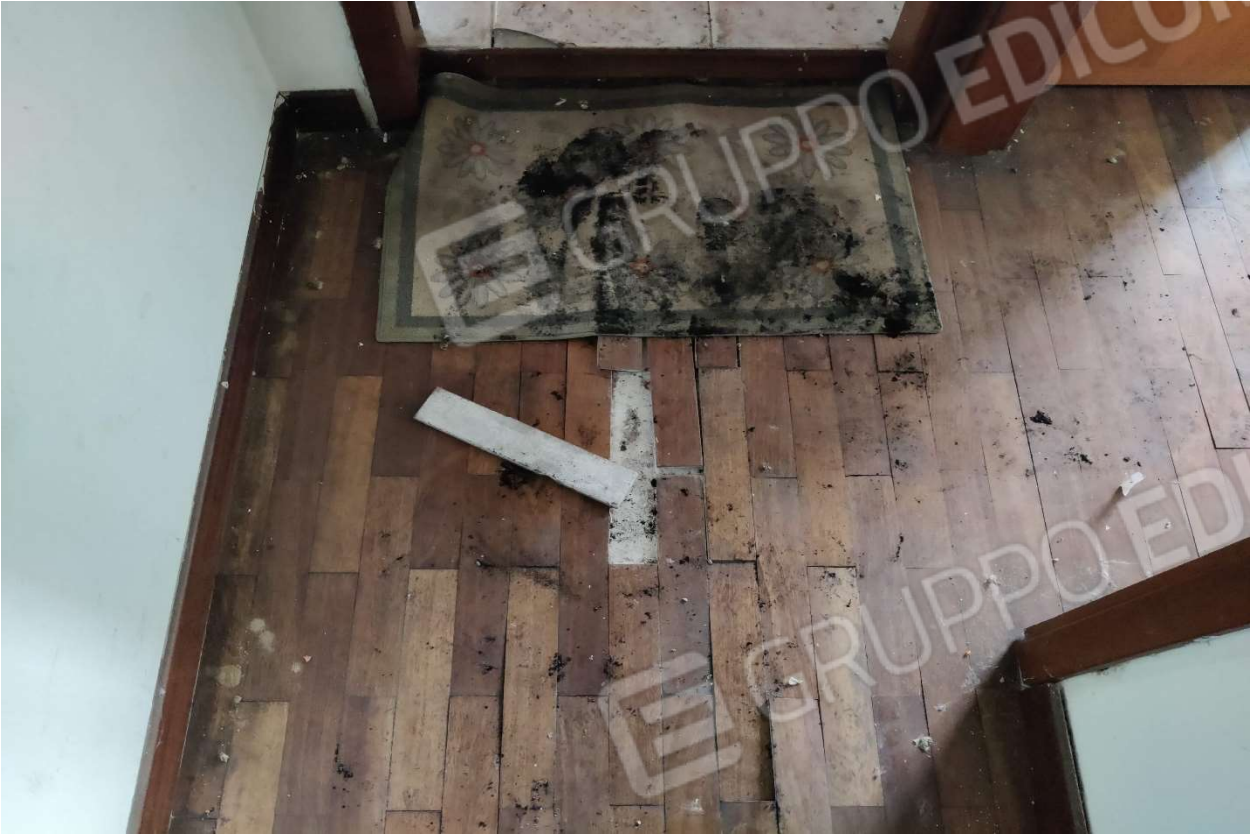
Foto n. 21 – Degradato generale alla pavimentazione.
