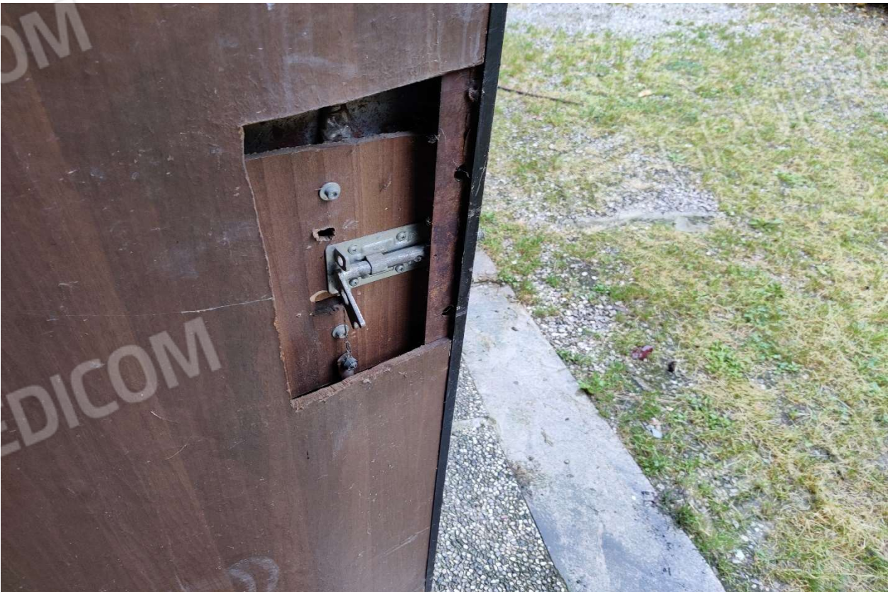
Foto n. 24 – Riparazioni non razionali ed antiestetiche.
