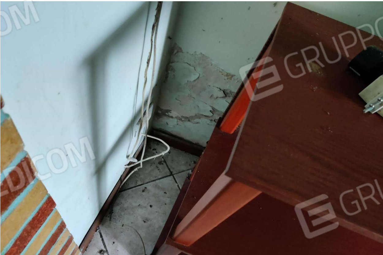
Foto n. 22 – Degradato generale alla parte muraria.
