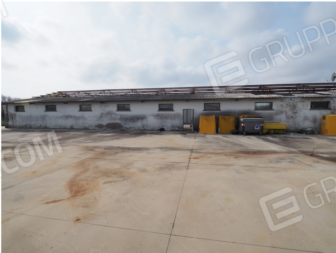
Caorle, strada Riello n. 2 – Il prospetto nord del capannone industriale e lo scoperto - area di manovra.
