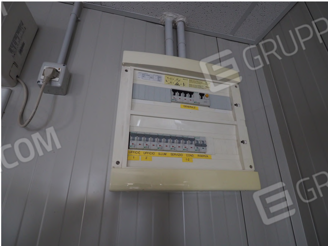
Caorle, strada Riello n. 2 – I particolari dell'impianto elettrico del prefabbricato.
