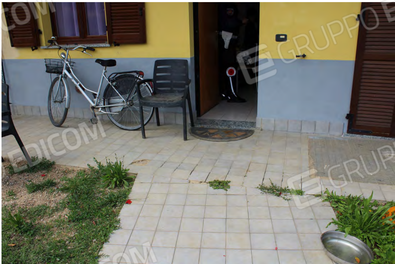
Particolare piastrelle sollevate davanti ingresso
