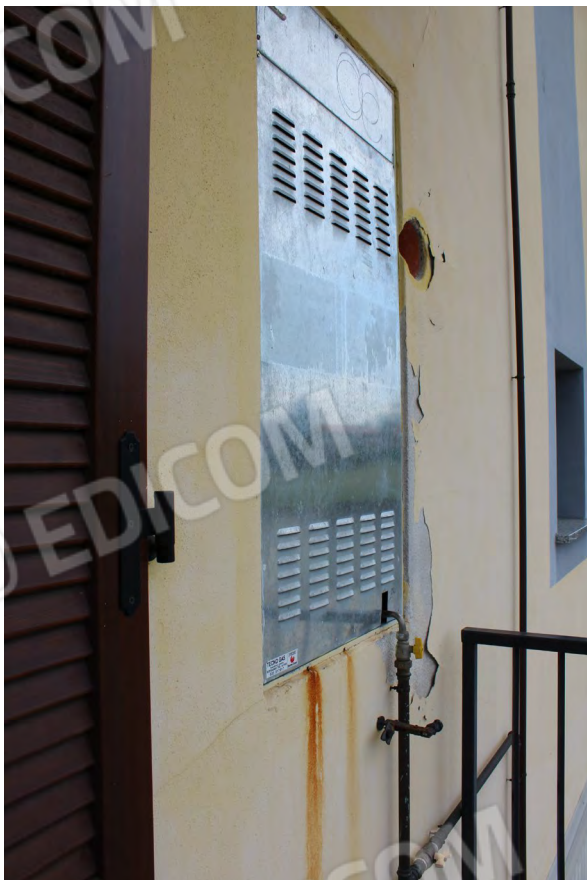
Caldaia su balcone
