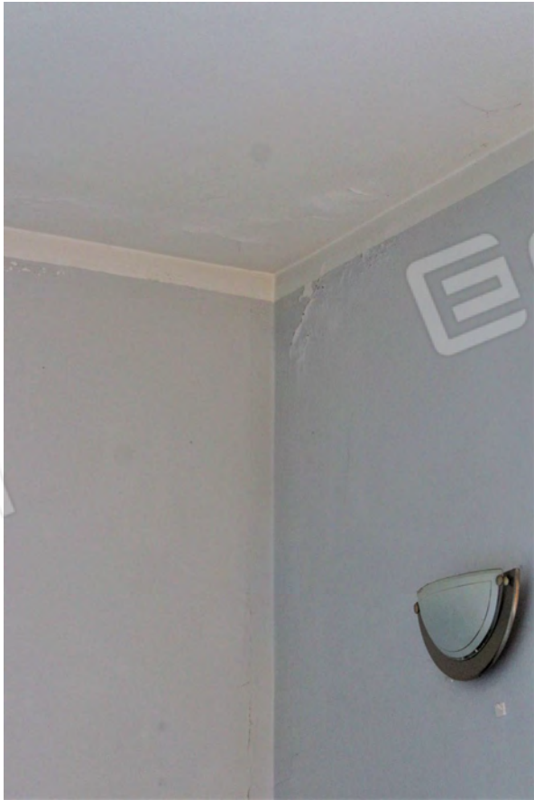
Infiltrazioni angolo soggiorno
