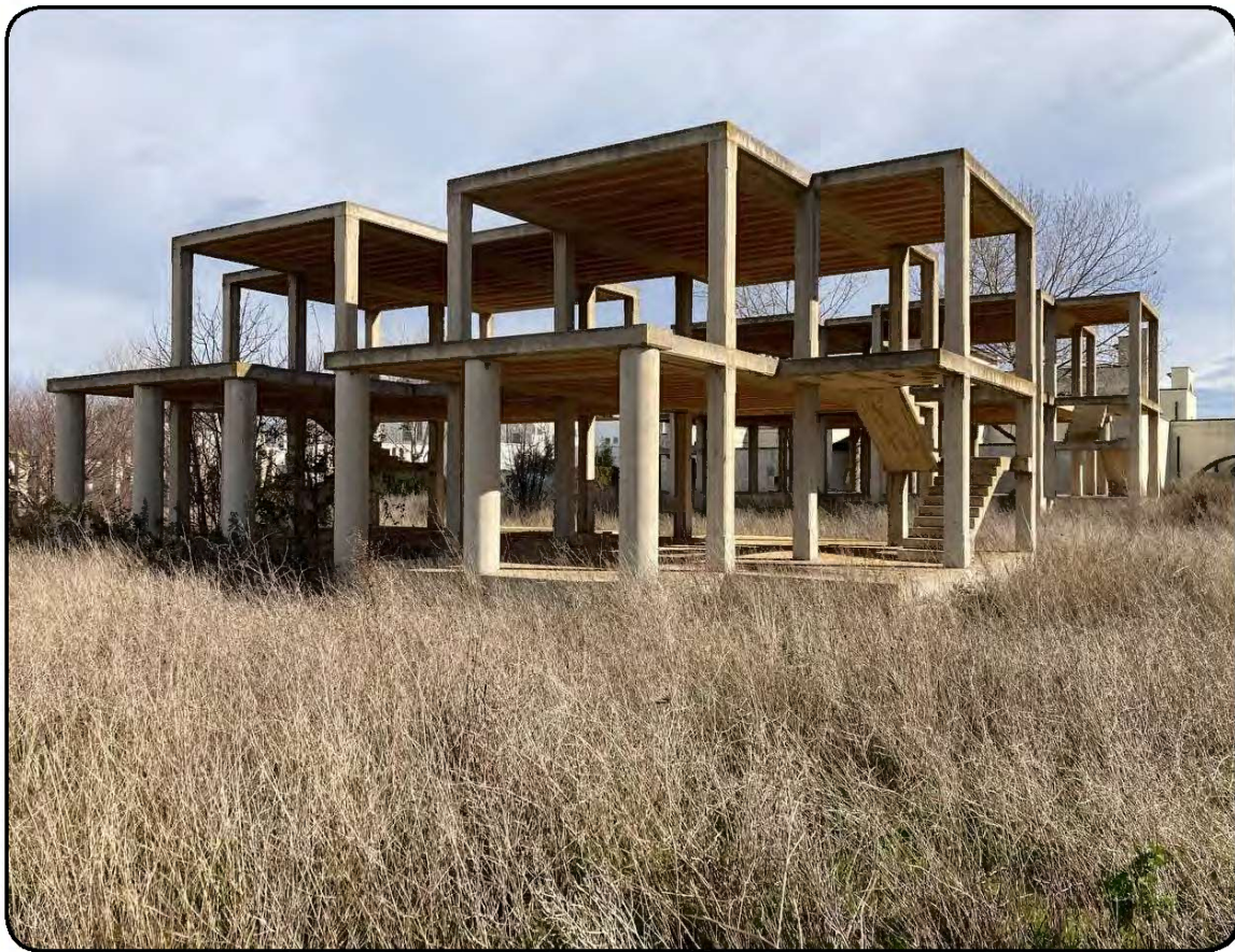
Foto 12: Struttura in c.a. di un corpo di fabbrica in costruzione in stato di abbandono relativa ad una villa del tipo Rossi 2 (cfr. Immagine 1 - cono visivo 6)
