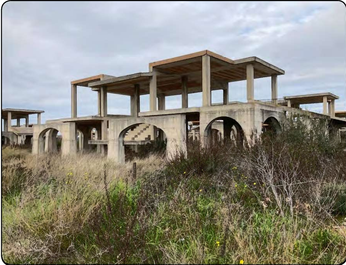
Foto 33: Struttura in c.a. di un corpo di fabbrica in costruzione in stato di abbandono relativa ad una villa del tipo Vietti 2 (cfr. Immagine 1 - cono visivo 18)
