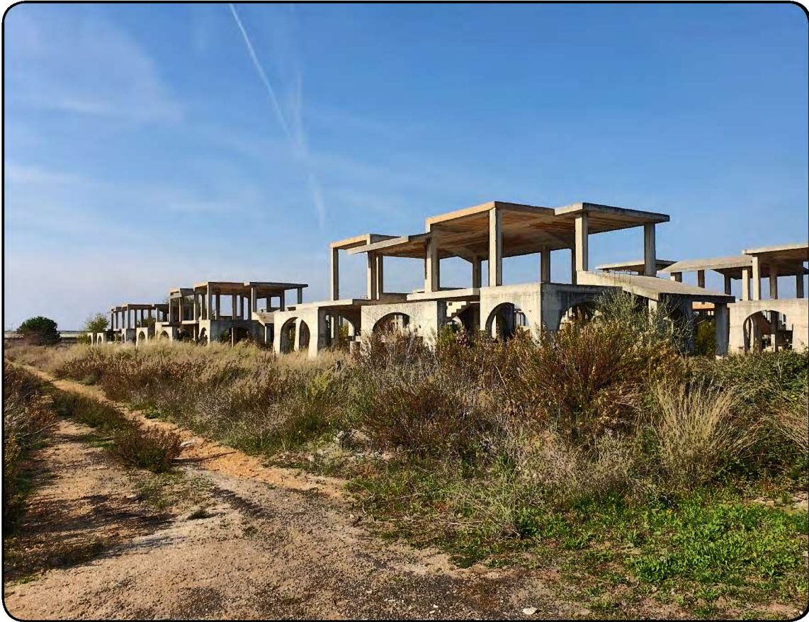
Foto 30: Strutture in c.a. dei corpi di fabbrica in costruzione in stato di abbandono relative alle ville del tipo Vietti 2
