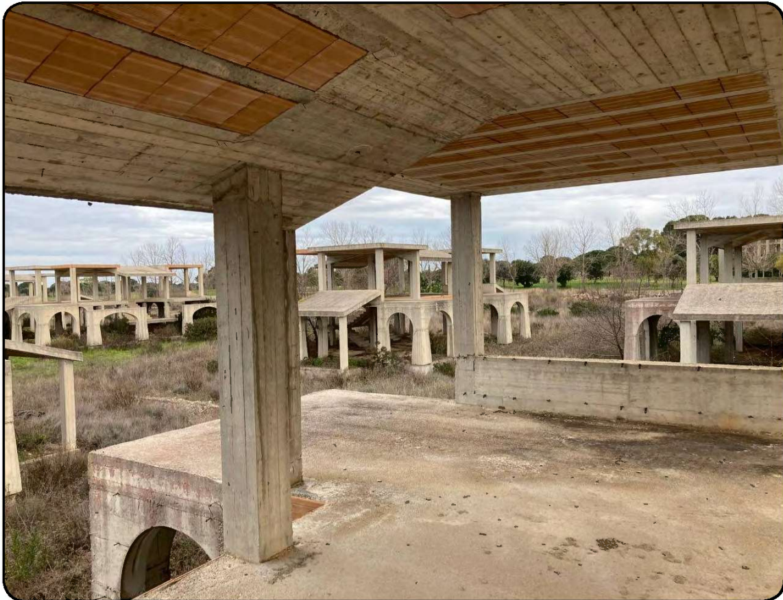
Foto 37: Vista di dettaglio dell'interno del Piano Primo di un corpo di fabbrica in costruzione in stato di abbandono relativa ad una villa del tipo Vietti 2 (cfr. Immagine 1 - cono visivo 18)
