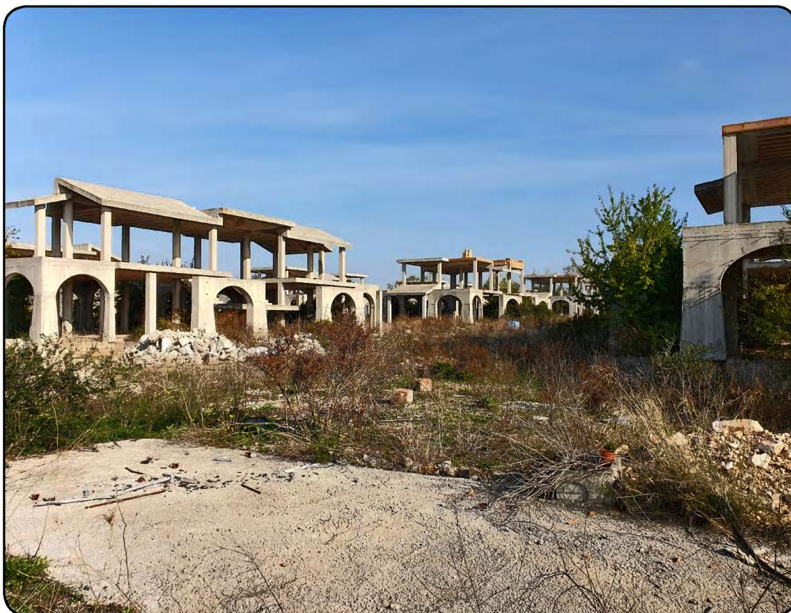
Foto 39: Strutture in c.a. dei corpi di fabbrica in costruzione in stato di abbandono relative alle ville del tipo Vietti 1 e del tipo Vietti 2
