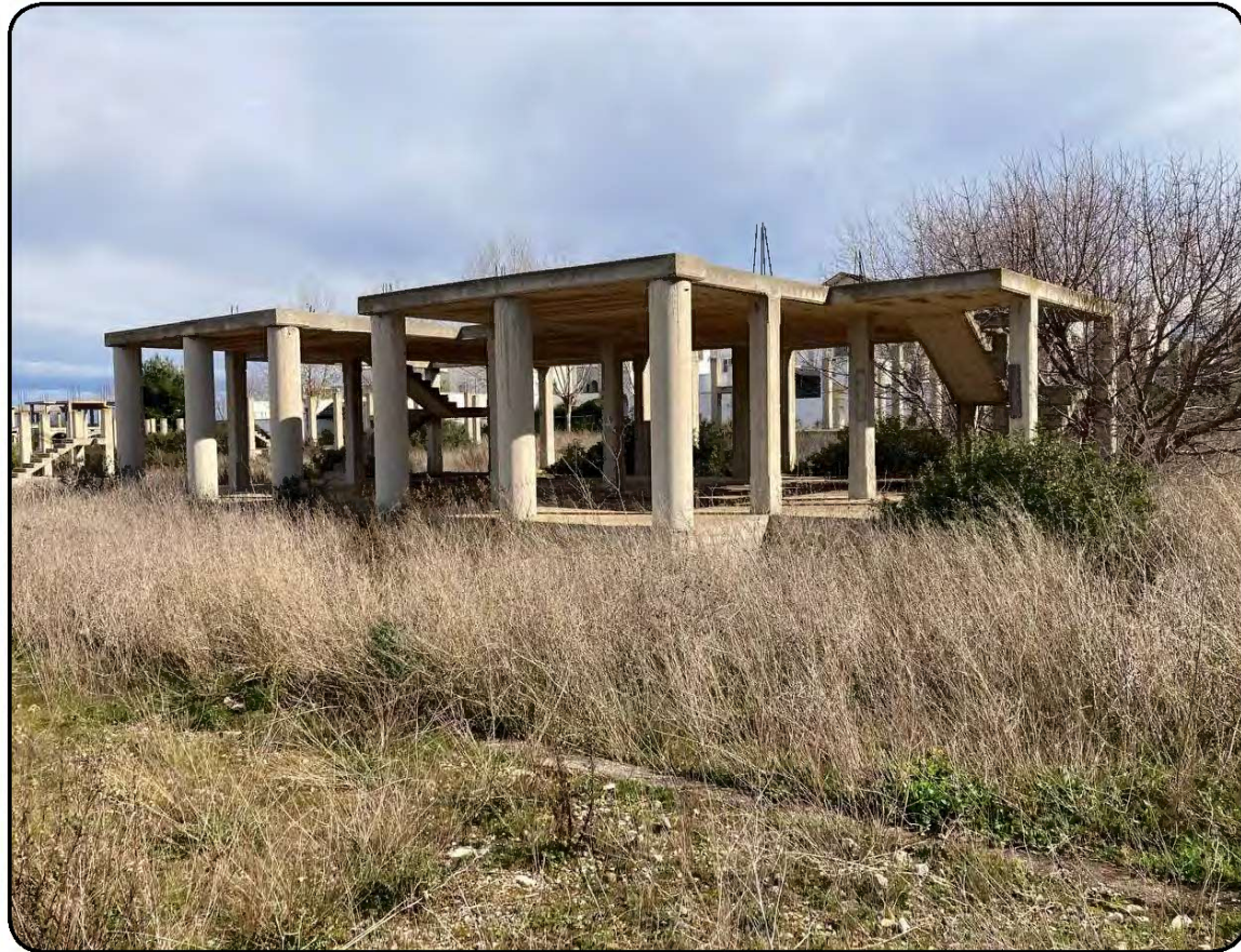
Foto 13: Struttura in c.a. della prima tesa dei pilastri di un corpo di fabbrica in costruzione in stato di abbandono relativa ad una villa del tipo Rossi 2 (cfr. Immagine 1 - cono visivo 7)
