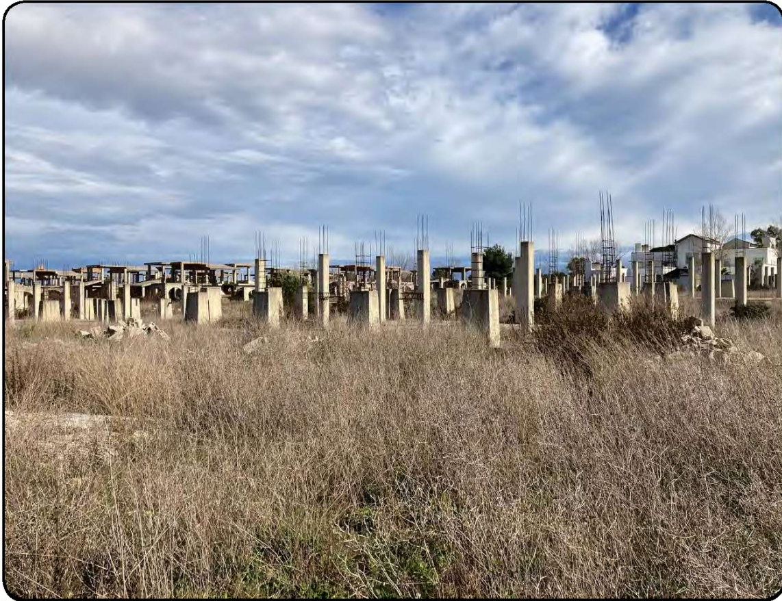
Foto 19: Struttura in c.a. della prima tesa dei pilastri di un corpo di fabbrica in costruzione in stato di abbandono, relativa ad una villa del tipo Vietti 2 (cfr. Immagine 1 - cono visivo 13)
