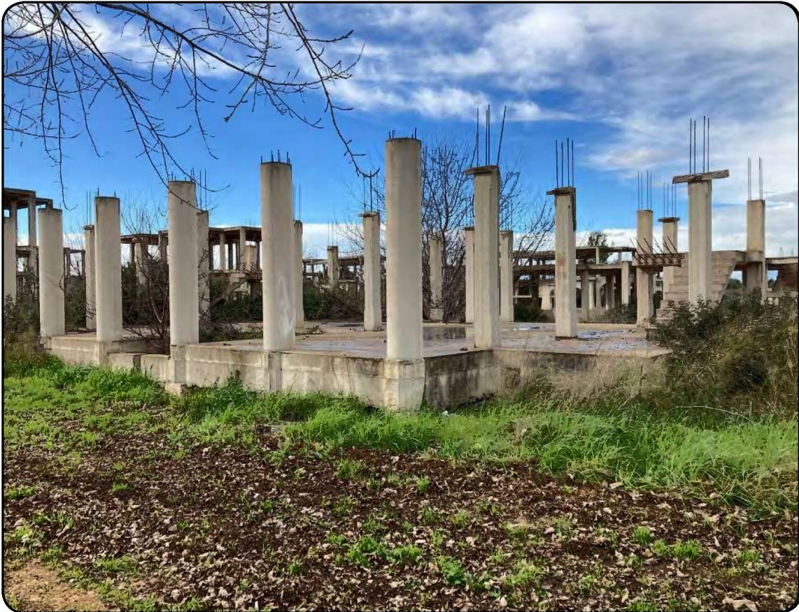
Foto 7: Struttura in c.a. della prima tesa dei pilastri di un corpo di fabbrica in costruzione in stato di abbandono relativa ad una villa del tipo Rossi 2 (cfr. Immagine 1 - cono visivo 2)
