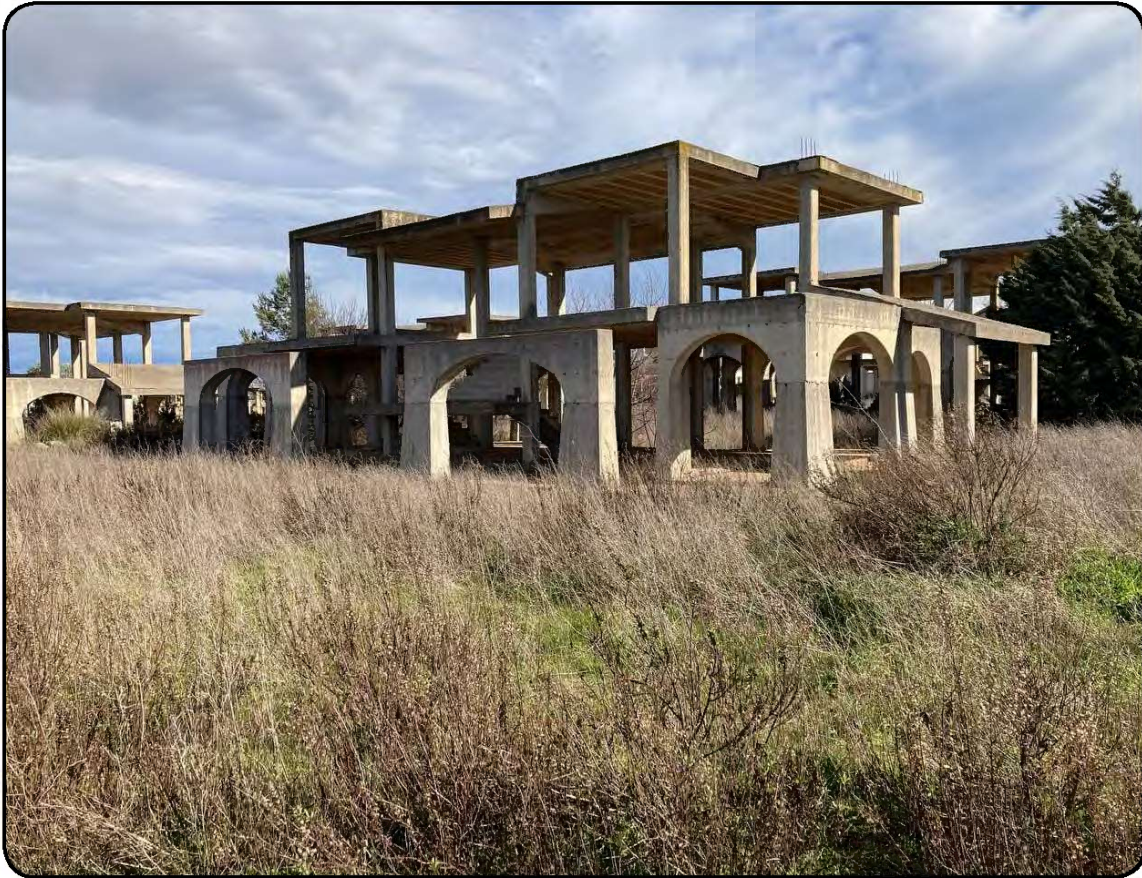
Foto 18: Struttura in c.a. di un corpo di fabbrica in costruzione in stato di abbandono, relativa ad una villa del tipo Vietti 2 (cfr. Immagine 1 - cono visivo 12)
