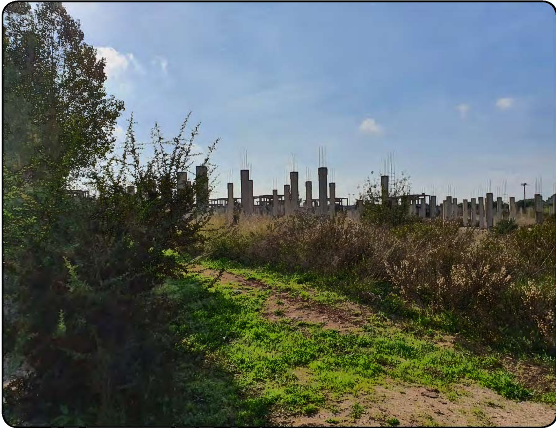
Foto 6: Strutture in c.a. della prima tesa dei pilastri dei corpi di fabbrica in costruzione in stato di abbandono relative alle ville del tipo Rossi 2
