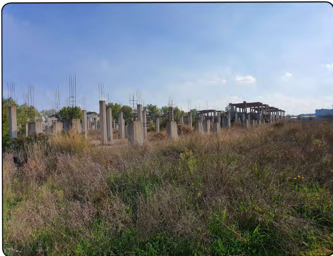
Foto 20: Strutture in c.a. della prima tesa dei pilastri dei corpi di fabbrica in costruzione in stato di abbandono, relative alle ville del tipo Vietti 2 (cfr. Immagine 1 - cono visivo 14)
