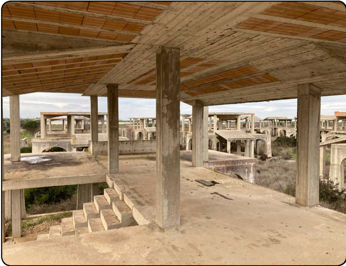
Foto 36: Vista di dettaglio dell'interno del Piano Primo di un corpo di fabbrica in costruzione in stato di abbandono relativa ad una villa del tipo Vietti 2 (cfr. Immagine 1 - cono visivo 18)
