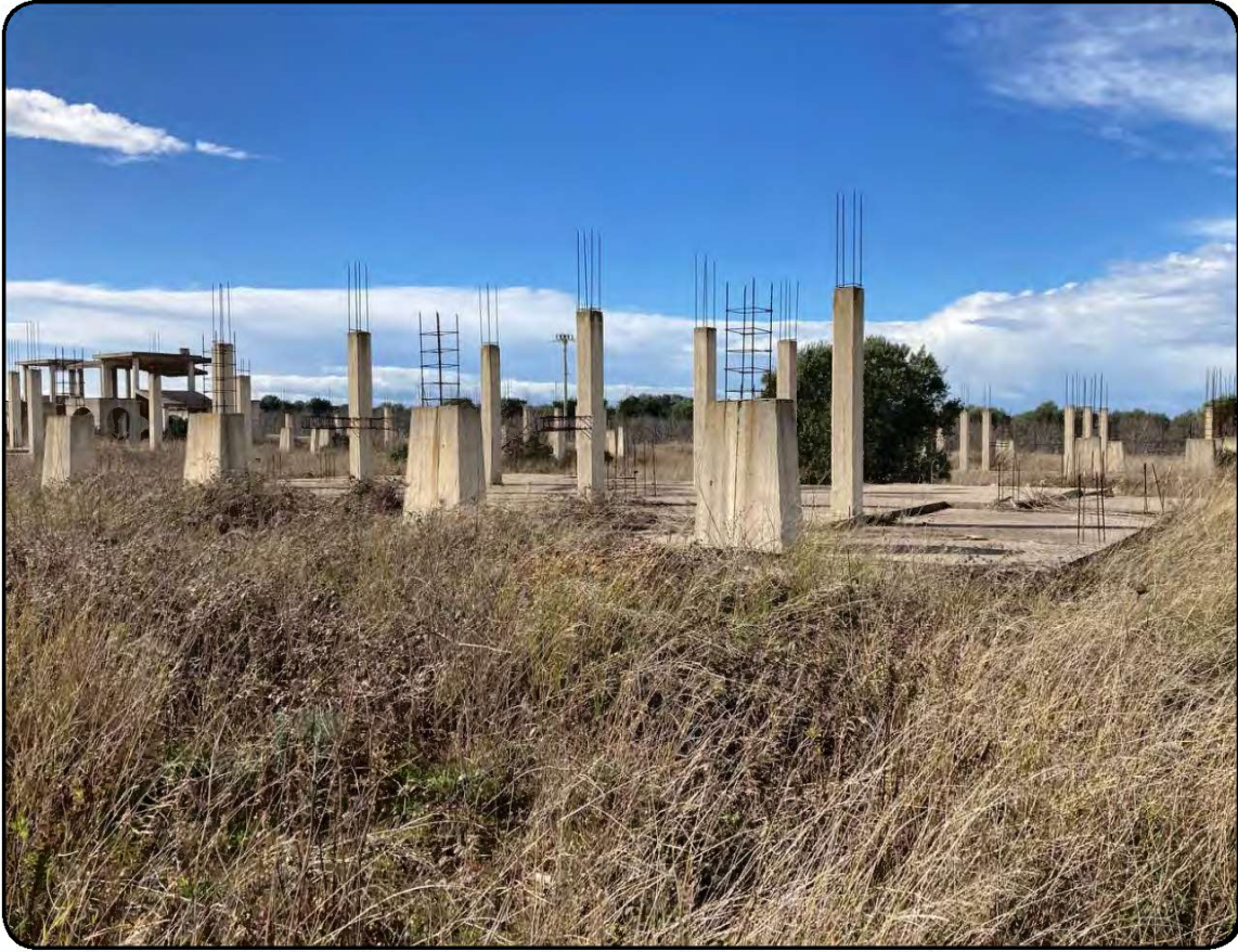
Foto 14: Struttura in c.a. della prima tesa dei pilastri di un corpo di fabbrica in costruzione in stato di abbandono, relativa ad una villa del tipo Vietti 2 (cfr. Immagine 1 - cono visivo 8)
