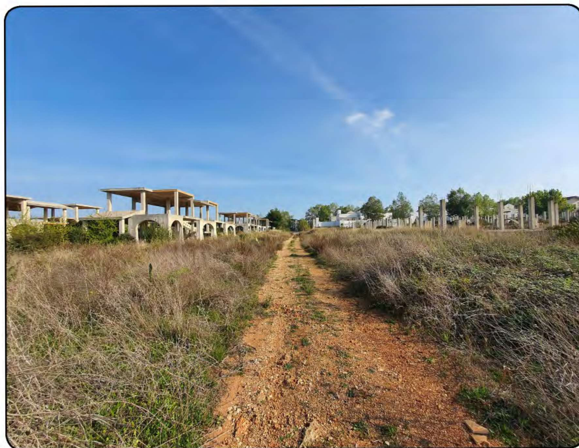
Foto 21: Strutture in c.a. dei corpi di fabbrica in costruzione in stato di abbandono, relative alle ville del tipo Vietti 2 (cfr. Immagine 1 - cono visivo 15)
