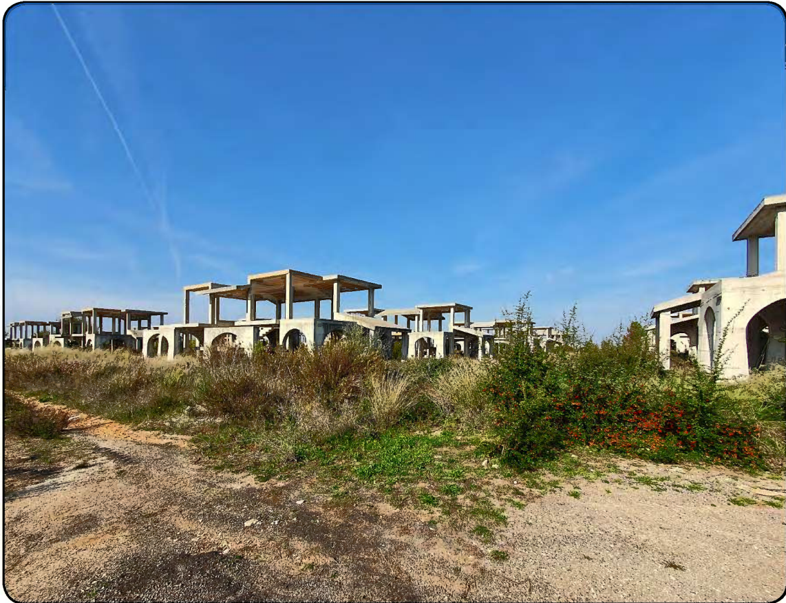
Foto 31: Strutture in c.a. dei corpi di fabbrica in costruzione in stato di abbandono relative alle ville del tipo Vietti 2
