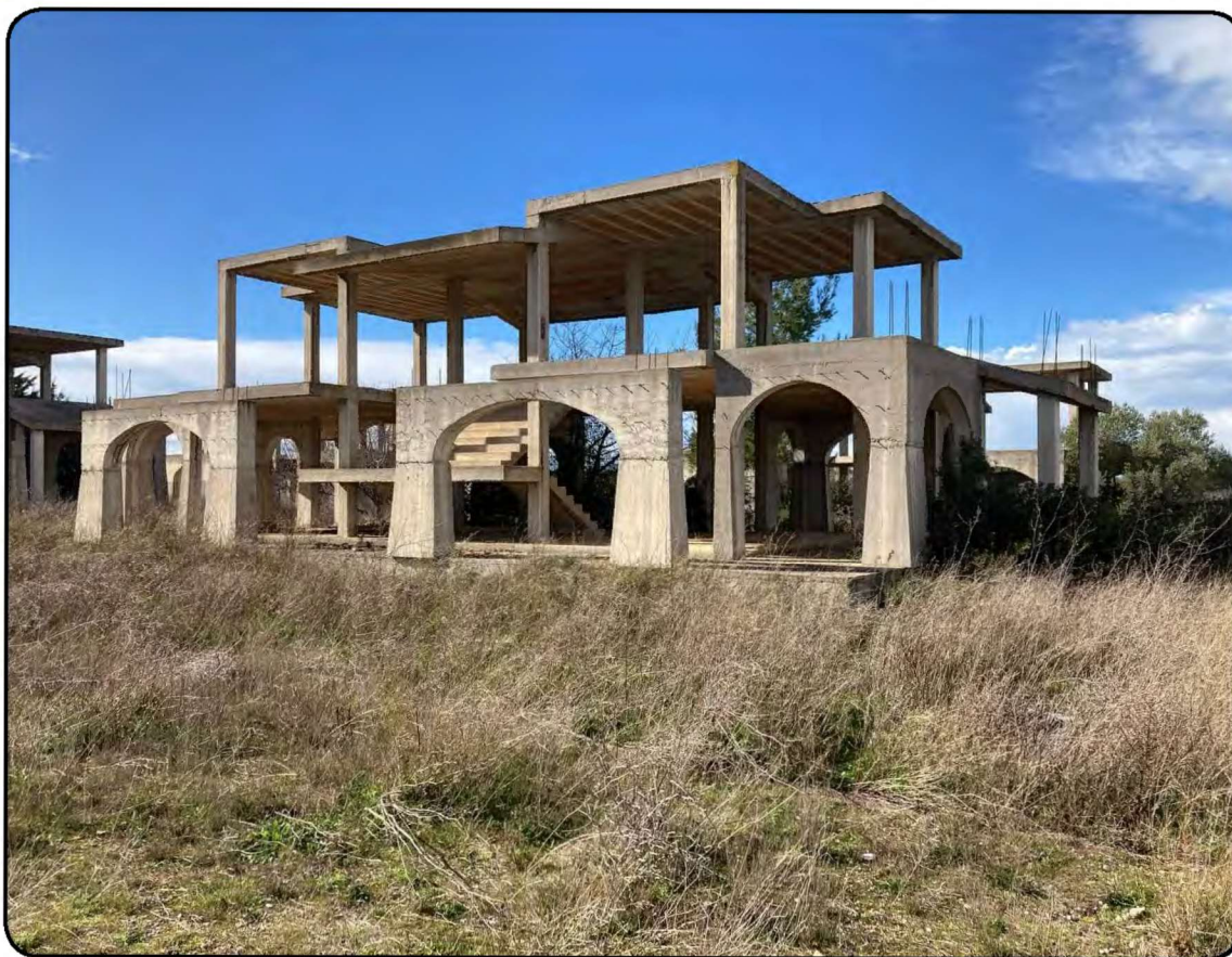
Foto 16: Struttura in c.a. di un corpo di fabbrica in costruzione in stato di abbandono, relativa ad una villa del tipo Vietti 2 (cfr. Immagine 1 - cono visivo 10)
