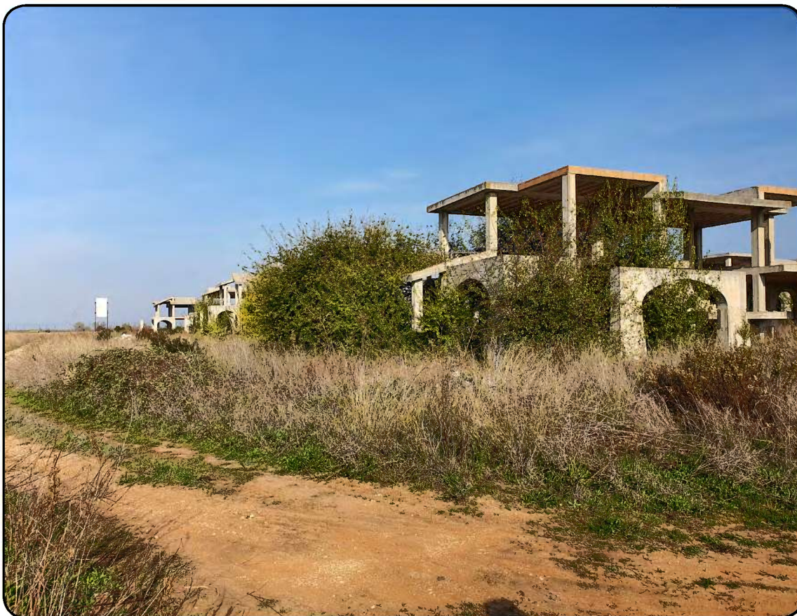
Foto 38: Struttura in c.a. di un corpo di fabbrica in costruzione in stato di abbandono relativa ad una villa del tipo Vietti 2 (cfr. Immagine 1 - cono visivo 19)
