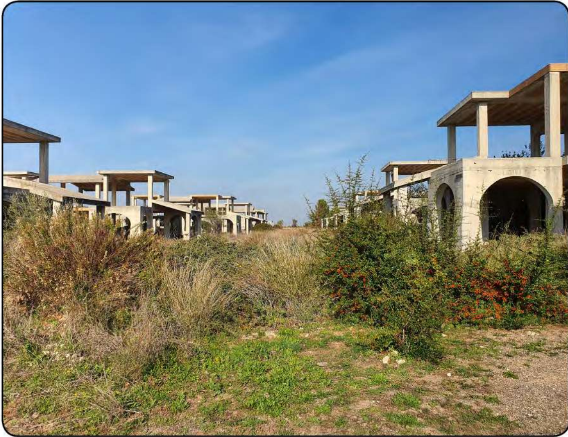
Foto 32: Strutture in c.a. dei corpi di fabbrica in costruzione in stato di abbandono relative alle ville del tipo Vietti 2 (cfr. Immagine 1 - cono visivo 17)
