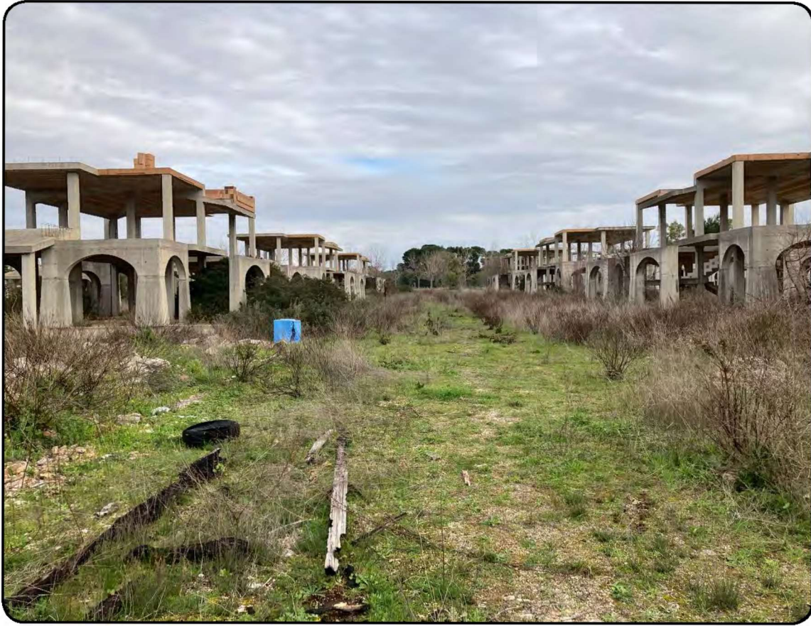
Foto 40: Strutture in c.a. dei corpi di fabbrica in costruzione in stato di abbandono relative alle ville del tipo Vietti 2 (cfr. Immagine 1 - cono visivo 20)
